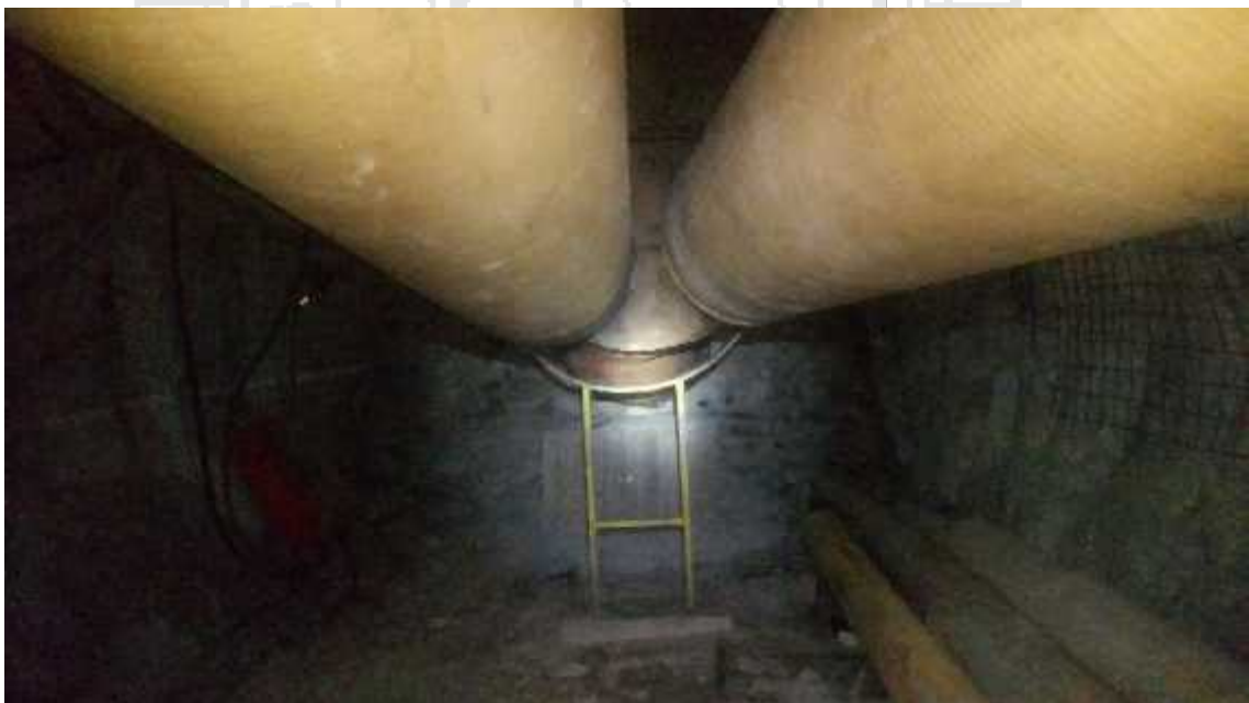
Figura 03.05: Salida del ventilador enseriado
