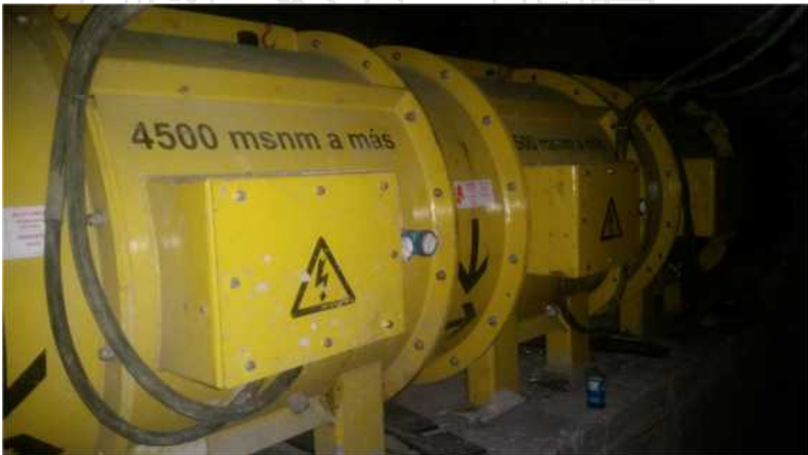
Figura 03.09: Ventiladores axial REMOVEX AB de 30000 cfm, instalados en la cortada, 3 ventiladores enseriados.
