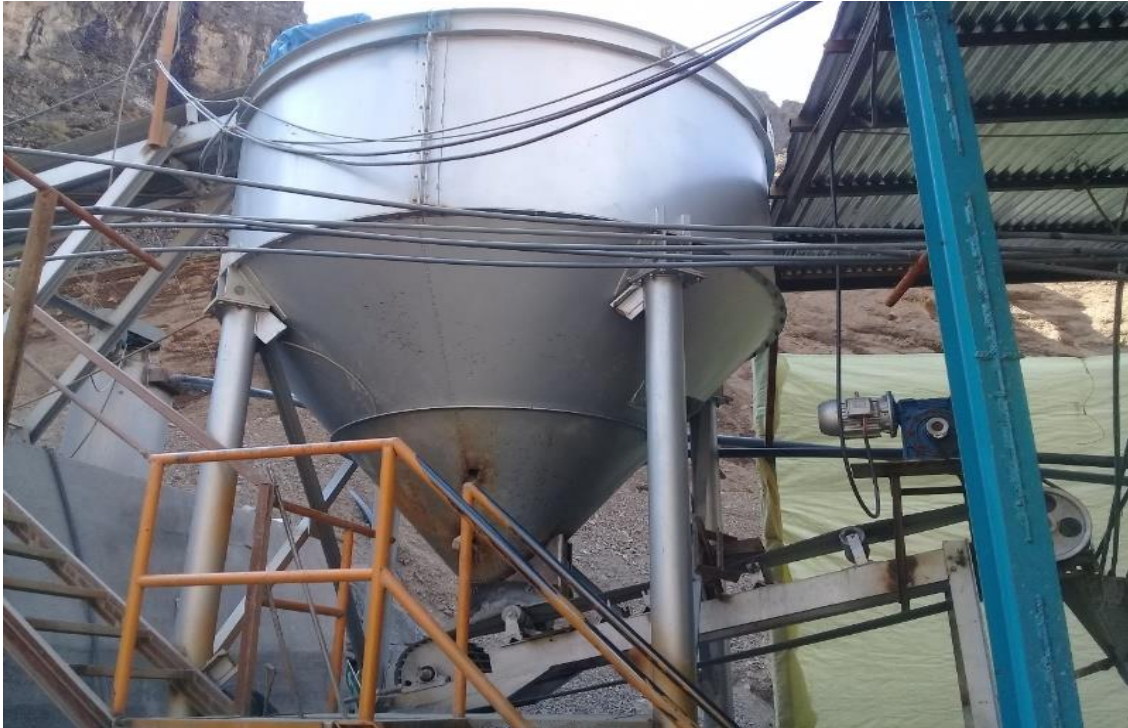
Se observa la tolva de finos y la faja N° 2 del Circuito de Molienda de la Planta San Carlos.
