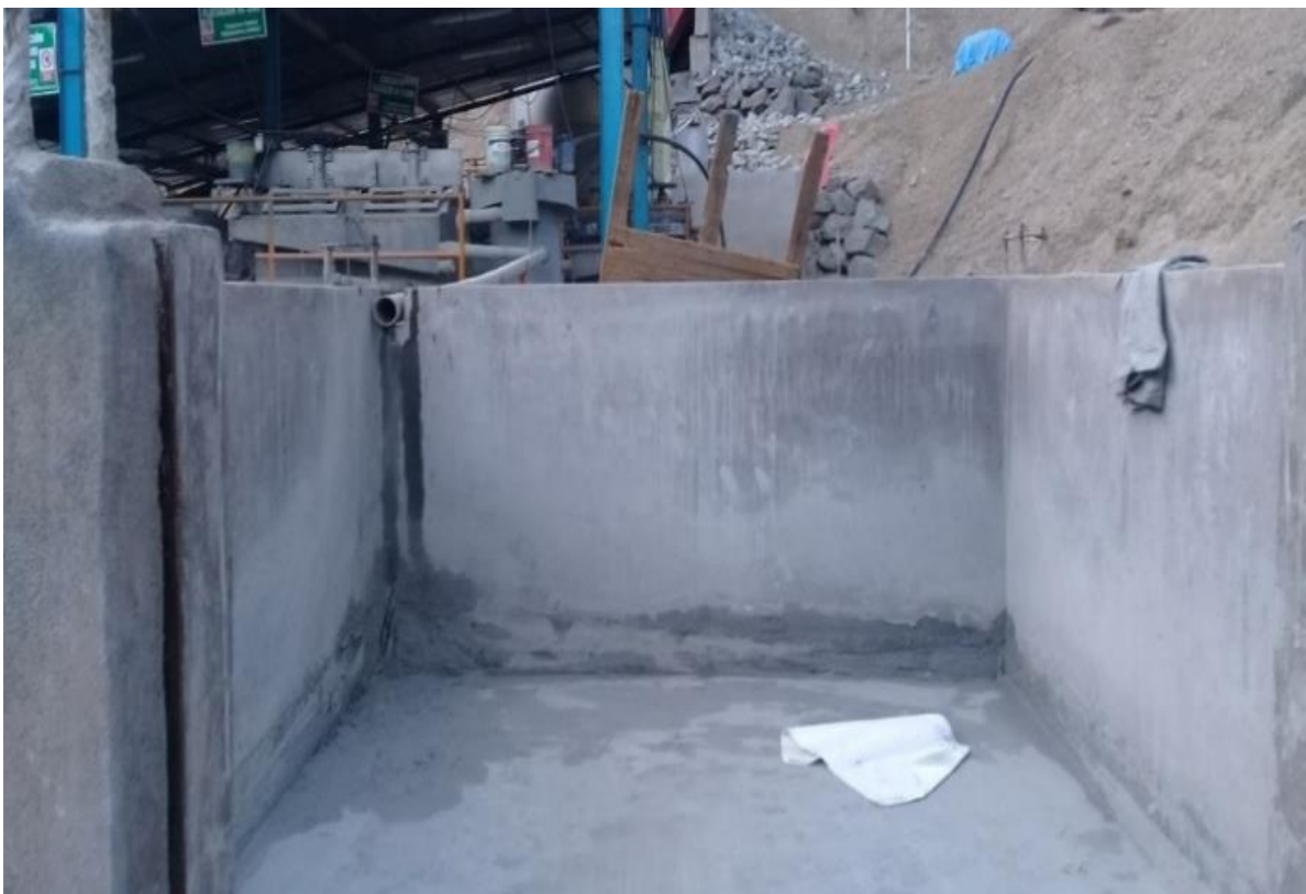
Cochas de concentrado de la Planta San Carlos.
