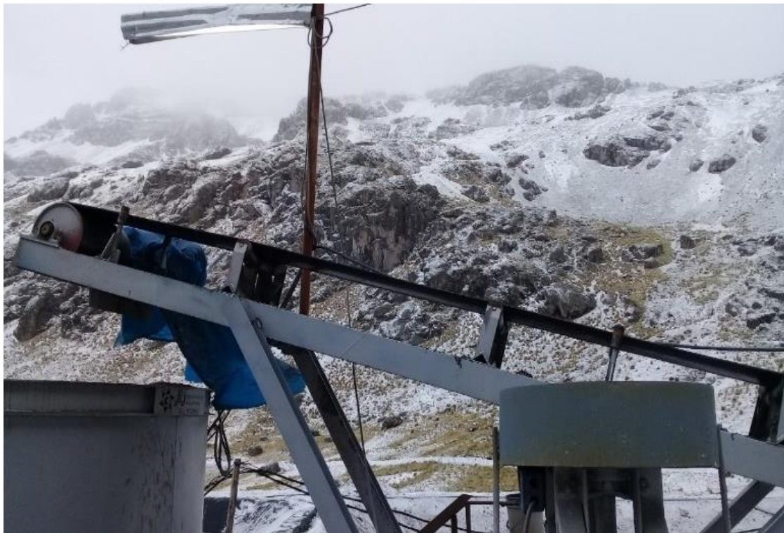
Faja transportadora N° 1 del circuito de Chancado de Planta San Carlos.
