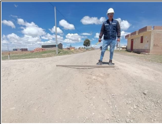
Foto 15: Km 2+500.00 - km 3+000.00, Se observa el deterioro (ahuellamiento) en la superficie de rodadura "afirmado".
