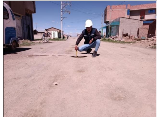
Foto 10: Km 0+000.00 - Km 0+500.00, Se observa la medición de la profundidad del deterioro (baches) en la superficie de rodadura "afirmado"
