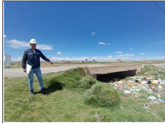
Foto 16: km 1+301.63, Se observa el ponton de concreto armado, tipo losa, se encuentra parcialmente obstruida y requiere limpieza.
