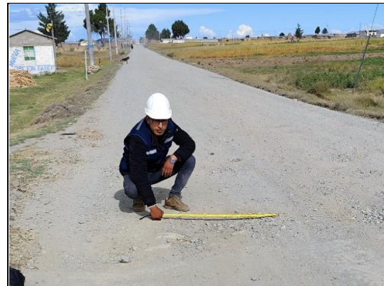
Foto 12: Km 1+000.00 - km 1+500.00, Se observa la medición de ancho promedio del deterioro (baches) en la superficie de rodadura "afirmado".
