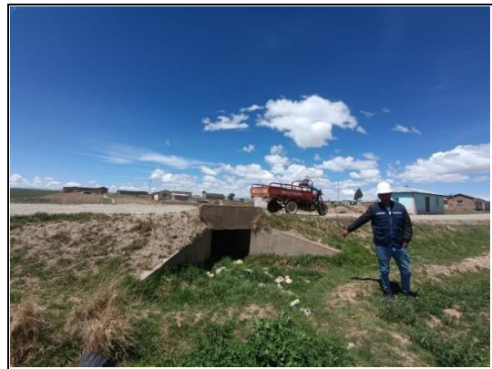
Foto 18: Km 2+791.73, Se observa la alcantarilla de concreto armado, obstruido parcialmente por vegetación, requiere limpieza.
