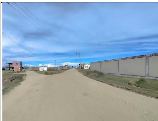
Foto 05: Km 00 + 592.10 se observa la via con tipo de superficie plano y tiene una transitabilidad regular a buena.
