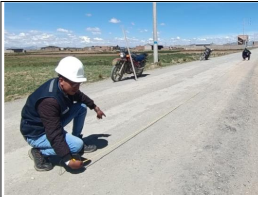
Foto 13: Foto 14: Km 1+500.00 - km 2+000.00, Se observa la medición de la longitud del deterioro (ahuellamiento) en la superficie de rodadura "afirmado".
