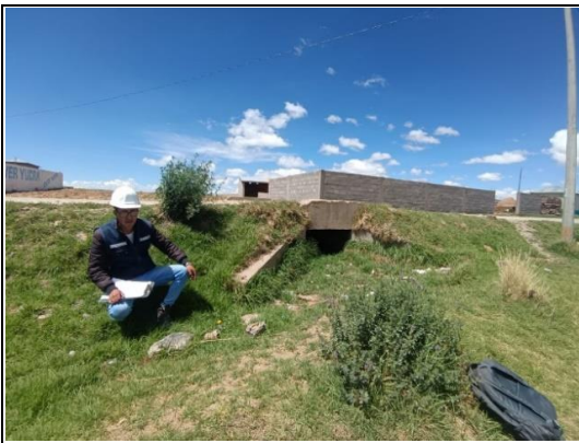
Foto 17: Km 2+331.10, Se observa la alcantarilla de concreto armado y se encuentra parcialmente obstruida por vegetación, requiere limpieza.
