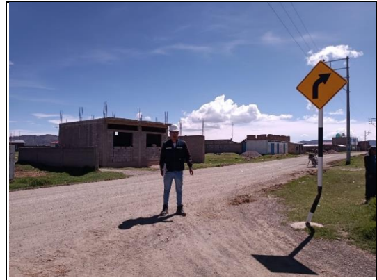
Foto 20: Km 0+426.87, Señal Preventiva al lado derecho de la vía, poste de soporte de fierro con dobles en la parte inferior del poste.
