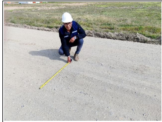
Foto 14: Km 2+000.00 - km 2+500.00, Se observa la medición del ancho del deterioro (ahuellamiento) en la superficie de rodadura "afirmado".
