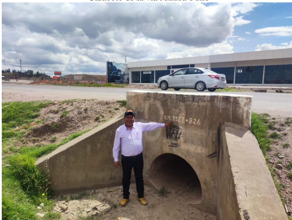
Fotografía 7 Residuos líquidos en las alcantarillas del tramo desde el Óvalo Zona Sur Juliaca hasta Caracoto de la vía Juliaca-Puno
