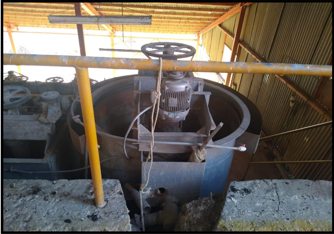
Figura A.13. Celda de acondicionamiento (Reactivos)
