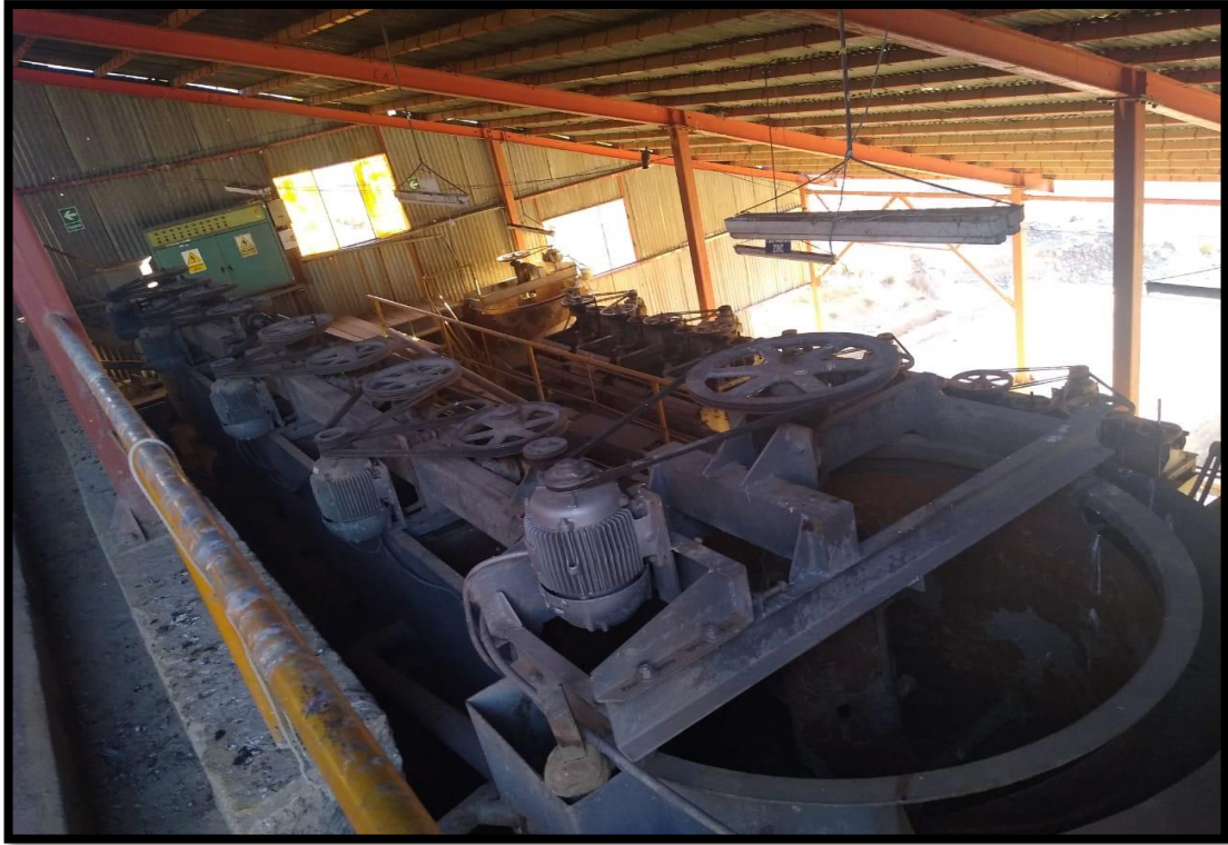
Figura A.11. Celdas de flotación
