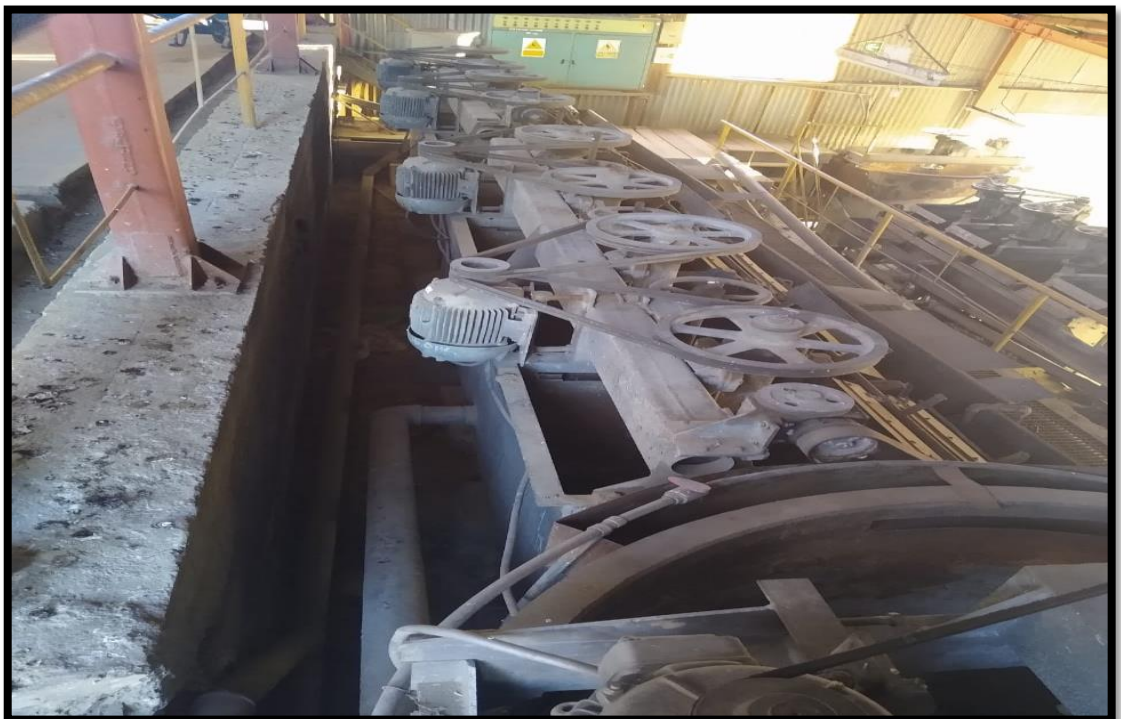
Figura A.8. Celdas de Flotación
