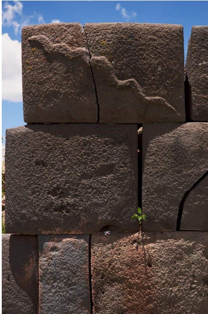
Figura 100. Agentes de deterioro, emplazamiento de Sillustani “4”
