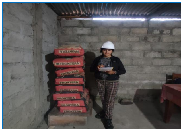
IMAGEN 03: ALMACENAMIENTO DEL CEMENTO SIN PROTECCIÓN DE POLIETILENO, EN EL DISTRITO DE SAN GABAN. KM 314+325
