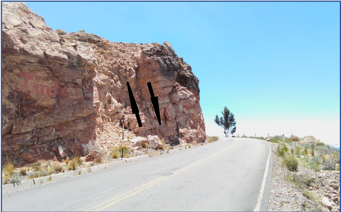
Figura 3. Falla normal tiene Azimut/buzamiento 115/76 NW. Km 55+400 N se ubica en las coordenadas 8296138 E 446430
