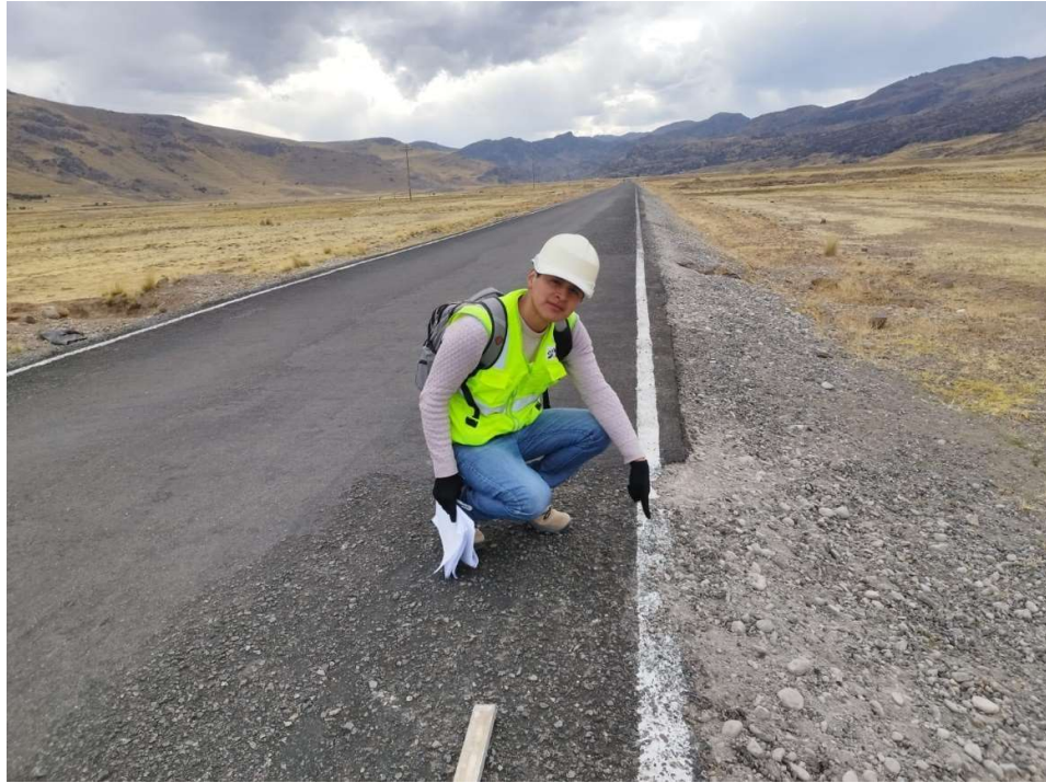
Fotografía N ° 05. Falla tipo 07 grieta de borde de severidad baja.
