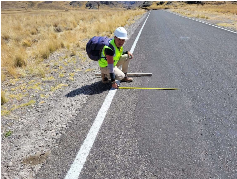
Fotografía N ° 04. Falla tipo 11 parcheo de bacheo y zanjas de severidad baja.
