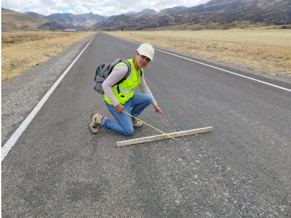
Fotografía N ° 08. Falla tipo 15 ahuellamiento de severidad baja del método del PCI.
