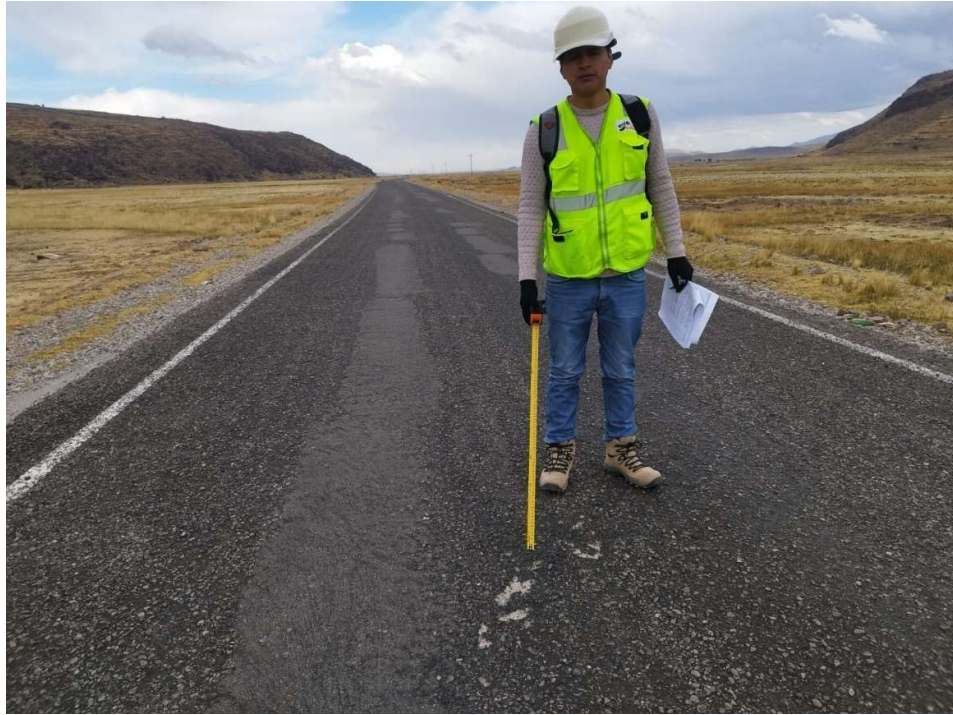
Fotografía N ° 07. Falla tipo 19 meteorización o desprendimiento de agregados de severidad baja del método del PCI.
