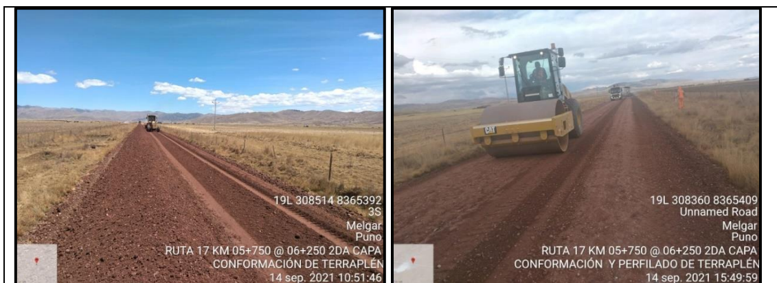
FOTOGRAFÍA 11 Y 12: Proceso de conformación, perfilado y compactación de la capa terraplén del km. 05+750 al km. 06+250.
