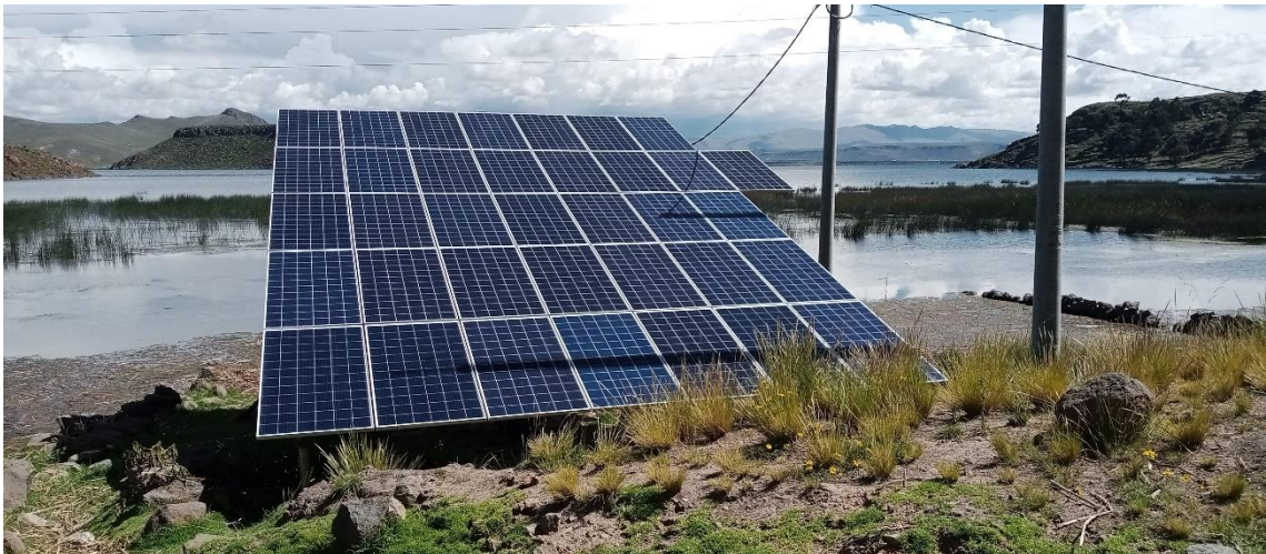
Figura 29. Vista del panel solar
