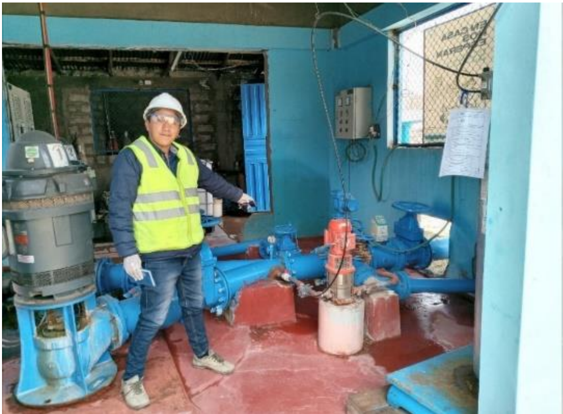
Punto de muestreo M3 Área planta de tratamiento de agua potable
