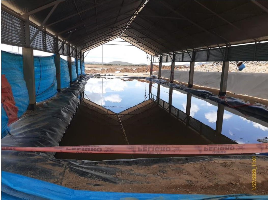
Foto 02. Derrame de lixiviados por rebose en la poza de almacenamiento de lixiviados.
