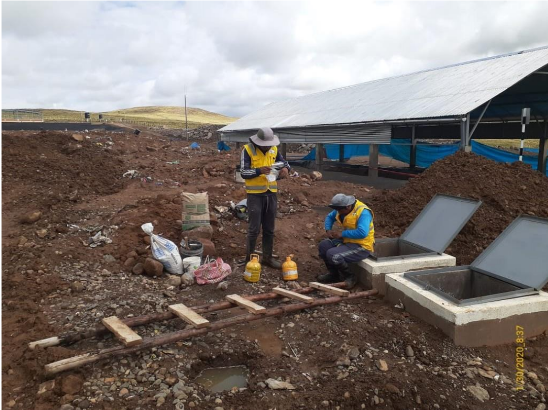
Foto 04. Se verifica chorros de lixiviado en las afueras de la caja de pluviales y recirculación de lixiviados.
