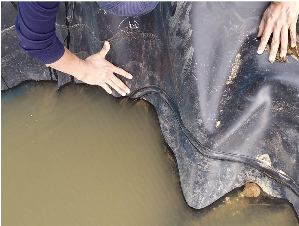
Foto 05. Descenso del nivel de lixiviados en la poza de almacenamiento de lixiviados por fuga en algún punto.
