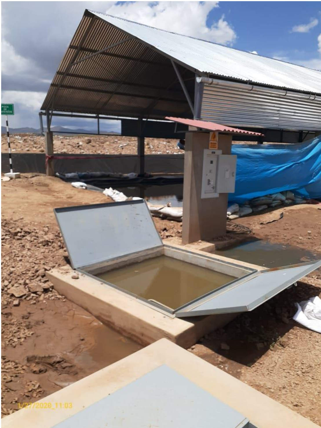
Foto 01. Derrame de lixiviados por rebose en la poza de bombeo para recirculación de lixiviados.
