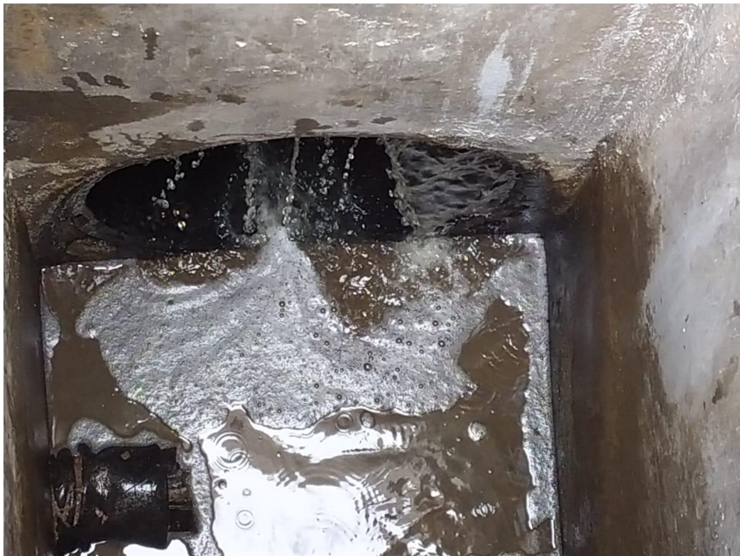
Foto 03. Filtración de lixiviados en la caja de inspección de evacuación de aguas pluviales.
