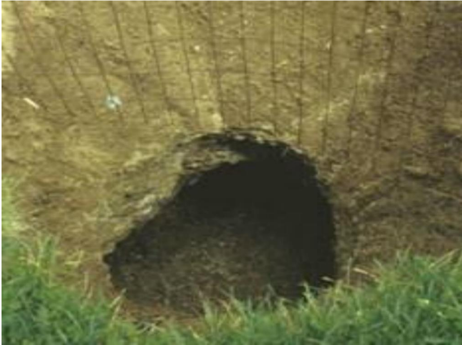
Figura 4. Pozo formado por colapso de una galería de escasa profundidad
