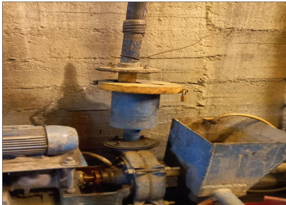
Figura 20. Bomba de lodos
