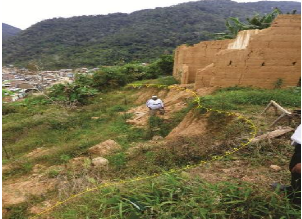
Figura 28 Salto de escarpa del deslizamiento en el talud superior.
