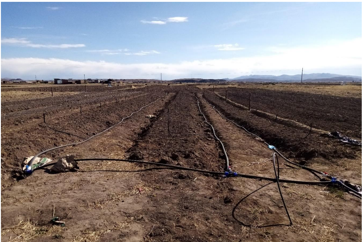
Foto 05. Instalación del sistema de riego por microaspersión – Bloques (B1, B2 y B3)
