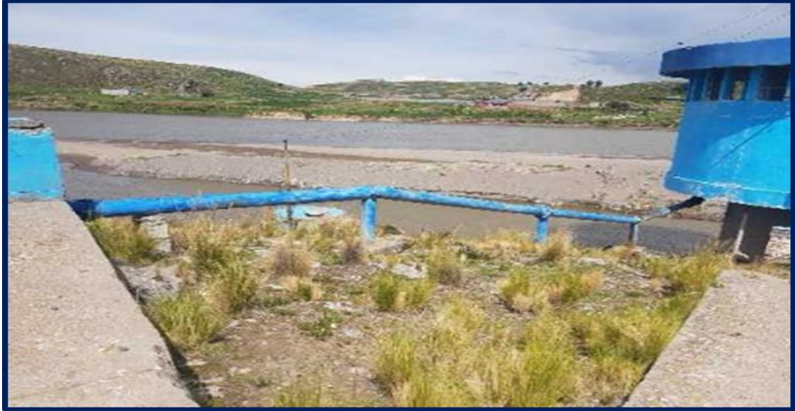
FOTOGRAFÍA 3: Líneas de impulsión de captación se unen en forma de “Y”
