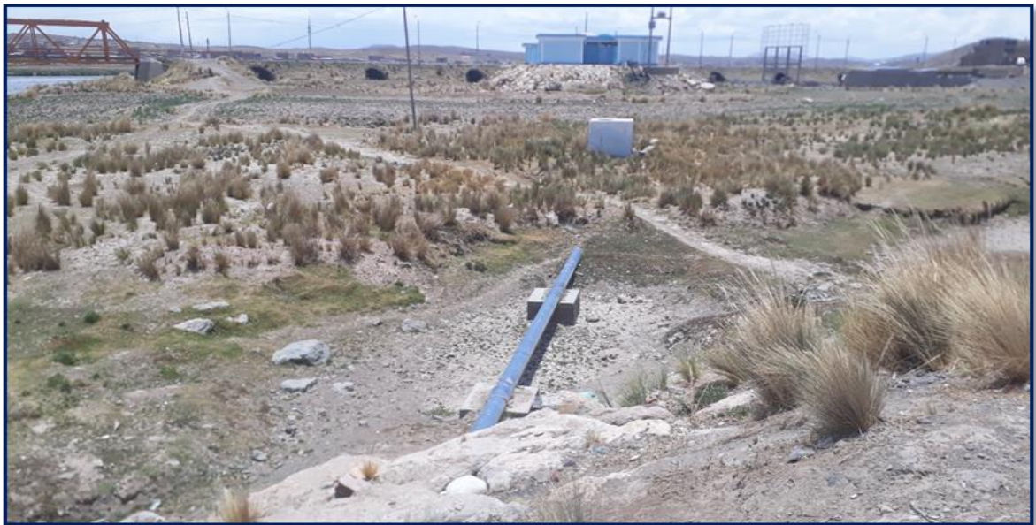
FOTOGRAFÍA 8: Actual Captación subterránea Puente Internacional (Pozo tubular)
