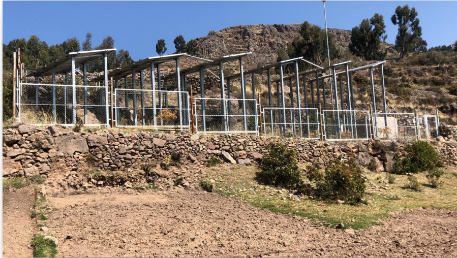
PANELES DE ENERGÍA SOLAR
