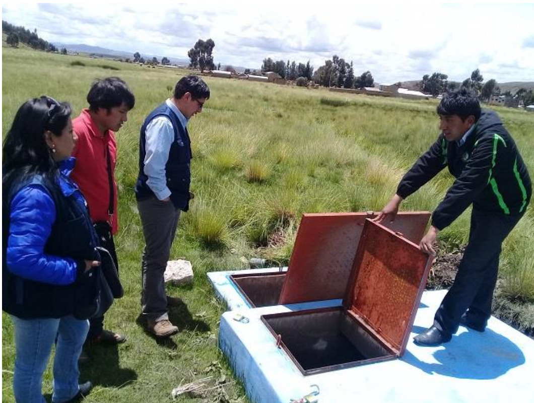
Figura 24: Vista de tanque de agua Elaborado por el equipo de trabajo
