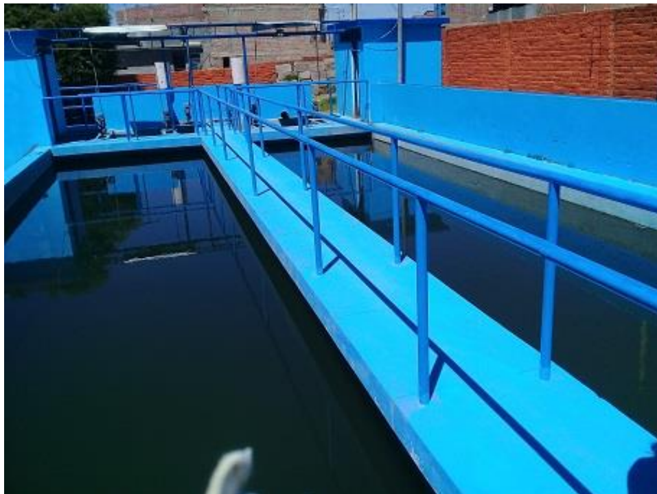
Figura 42: Tratamiento de agua llave Elaborado por el equipo de trabajo
