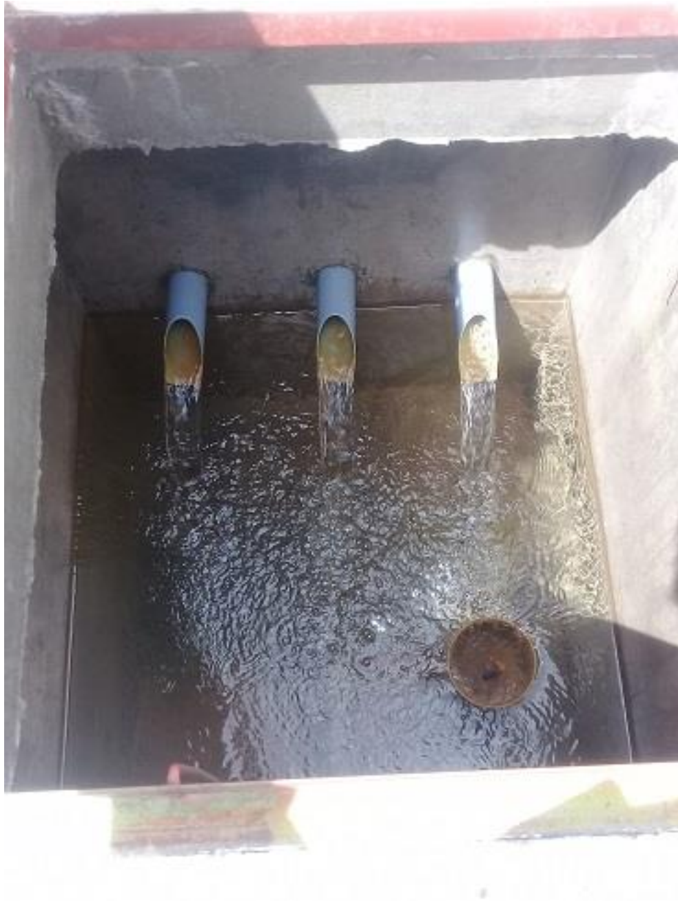
Figura 47: Agua clorada Juli Elaborado por el equipo de trabajo
