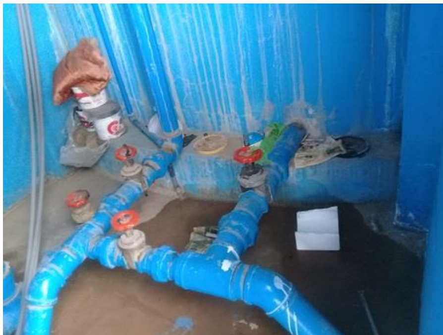
Figura 28: Tuberías Capachica Elaborado por el equipo de trabajo
