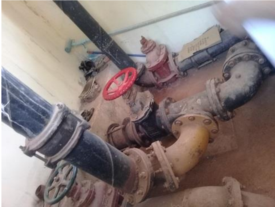
Figura 45: Tuberías de agua Juli Elaborado por el equipo de trabajo
