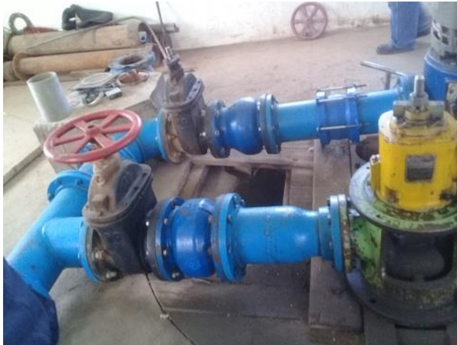
Figura 39: Tuberías de agua Ilave Elaborado por el equipo de trabajo
