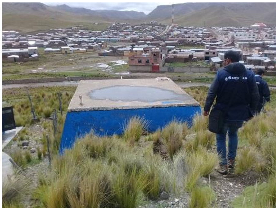
Figura 49: Reservorio de agua Santa Lucia Elaborado por el equipo de trabajo
