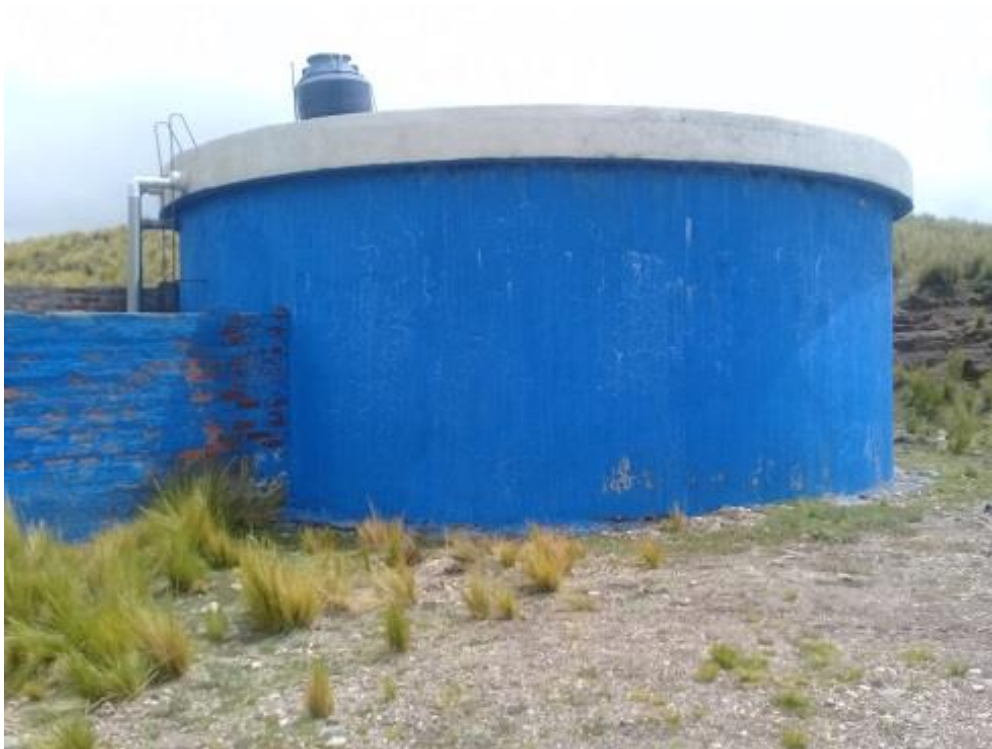
Figura 48: Reservorio de agua Santa Lucia Elaborado por el equipo de trabajo
