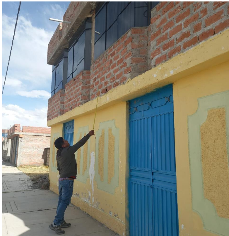
Figura A. 7 Verificación de las juntas verticales y horizontales en la vivienda V-40, realizado en la fecha 12/05/22
