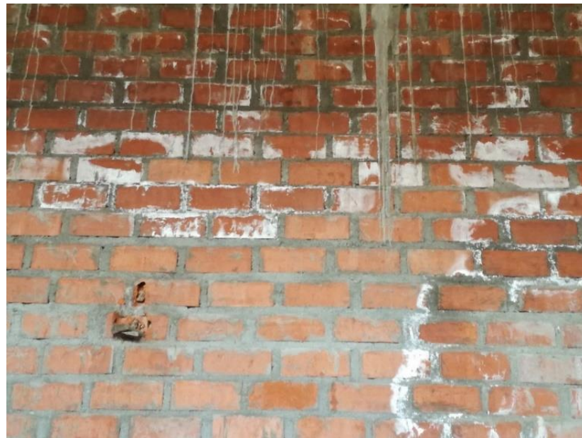
Figura 40: Existencia de la eflorescencia en la vivienda V-9 Fuente: Elaborado por el equipo de trabajo en la fecha 12/12/21
