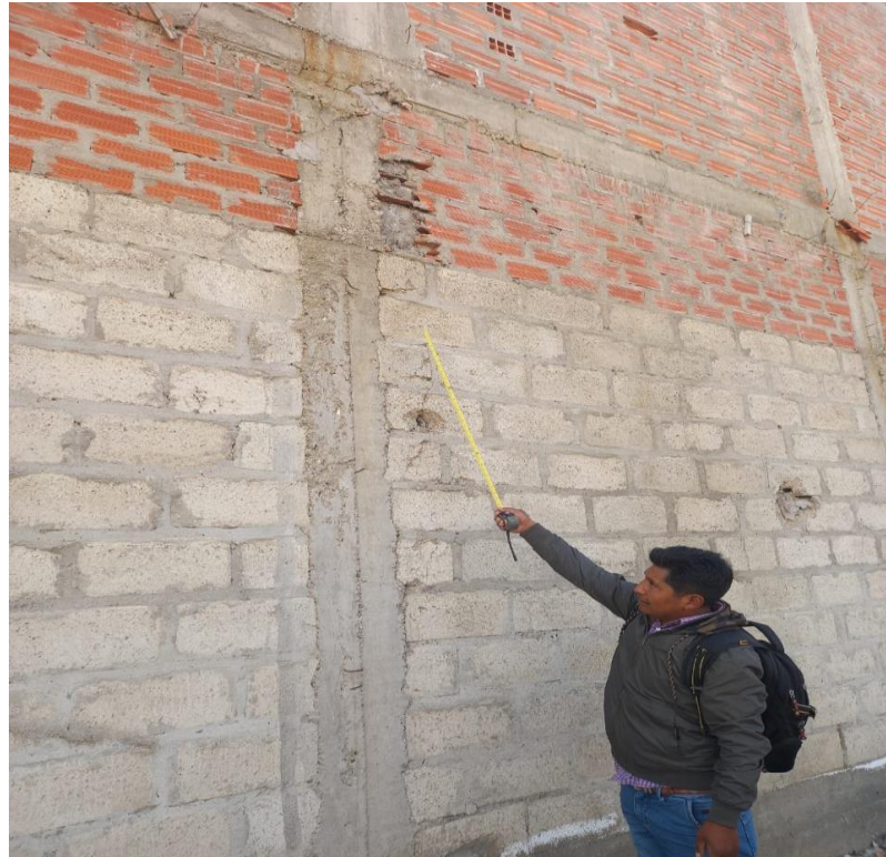
Figura 10: Verificación de los defectos de la construcción de la vivienda V-15 Fuente: Elaborado por el equipo de trabajo en la fecha 12/05/22
