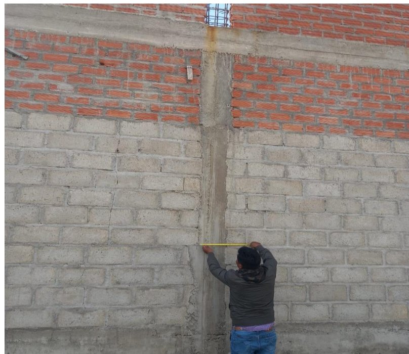
Figura A. 6 Verificación del ancho uniforme de la columna en la vivienda V-25, realizado en la fecha 12/05/22
