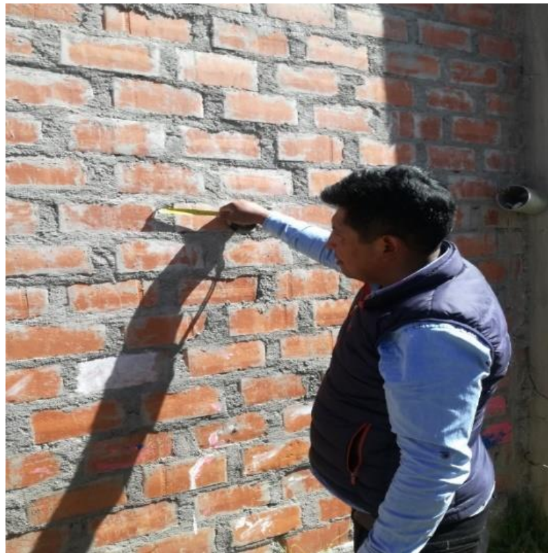
Figura 38: Medición de las juntas de mortero en la vivienda V-7 Fuente: Elaborado por el equipo de trabajo en la fecha 07/12/21
