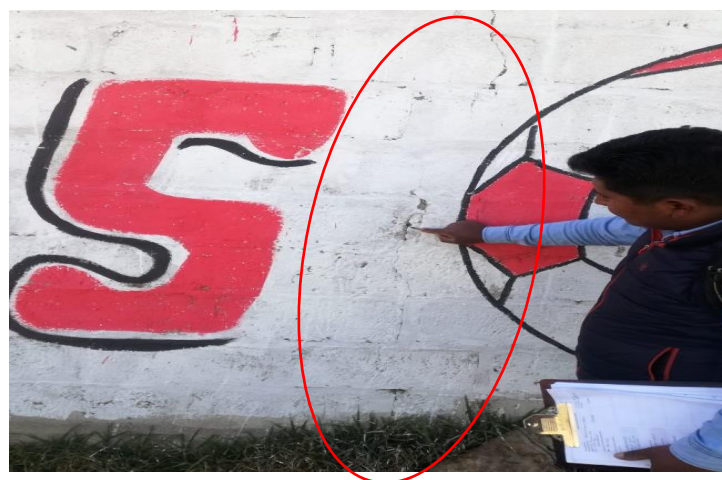
Figura 42: Fisura en el muro exterior de la vivienda V-3 Fuente: Elaborado por el equipo de trabajo en la fecha 07/12/21
