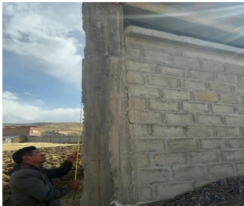
Figura A. 8 Verificación del ancho uniforme de la columna en la vivienda V-45, realizado en la fecha 12/05/22
