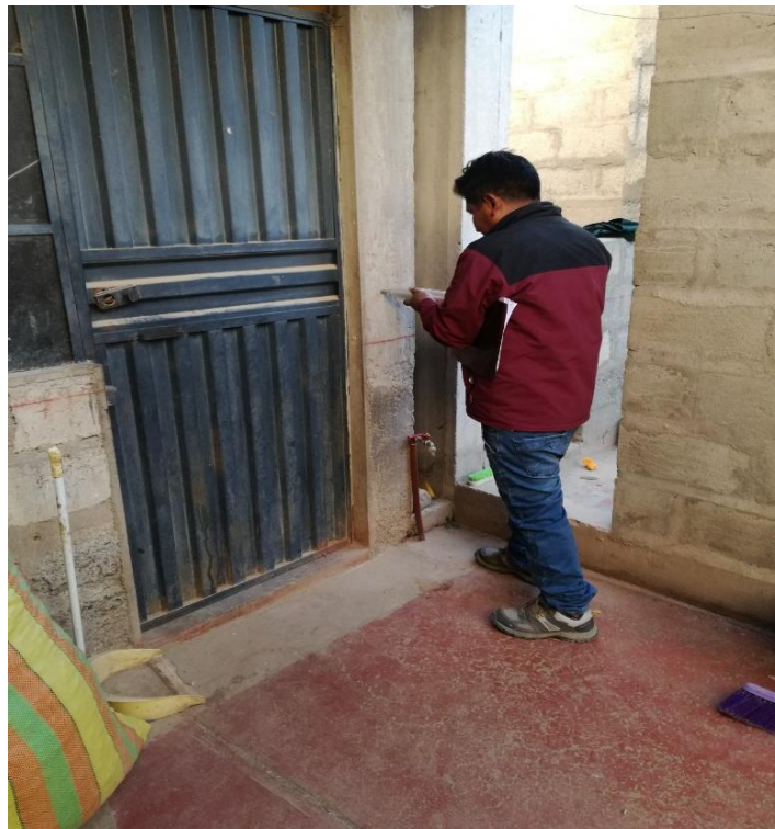
Figura A. 11 Medición de la resistencia del concreto en columnas en la vivienda V-58, realizado en la fecha 09/05/22
