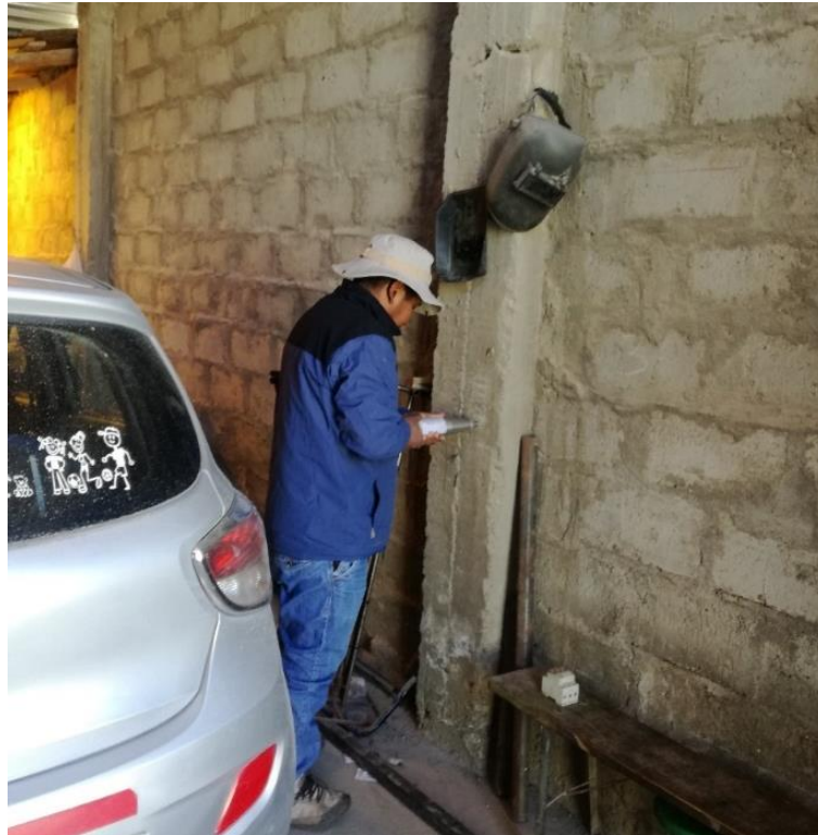
Figura A. 13 Medición de la resistencia del concreto en columnas en la vivienda V-12, realizado en la fecha 15/05/22
