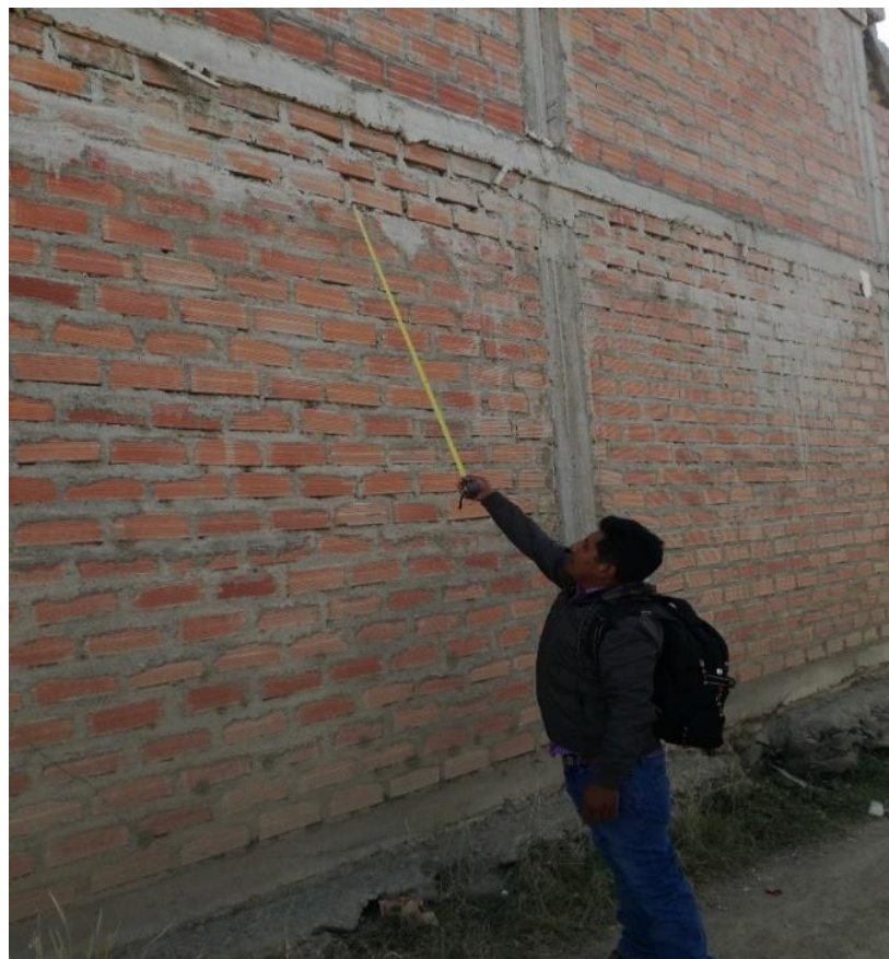
Figura 34: Existencia de la mala confinación entre el muro y la losa aligerada en la vivienda V-31
