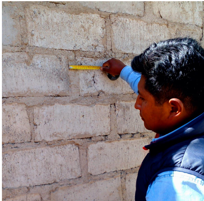
Figura A. 5 Verificación de las juntas verticales y horizontales en la vivienda V-21, realizado el 07/12/21
