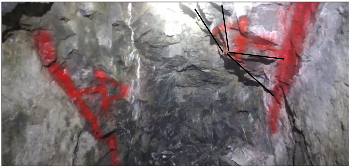
Foto 1. Se muestra en el techo cuña de manera favorable para la estabilidad de la excavación al minado.
