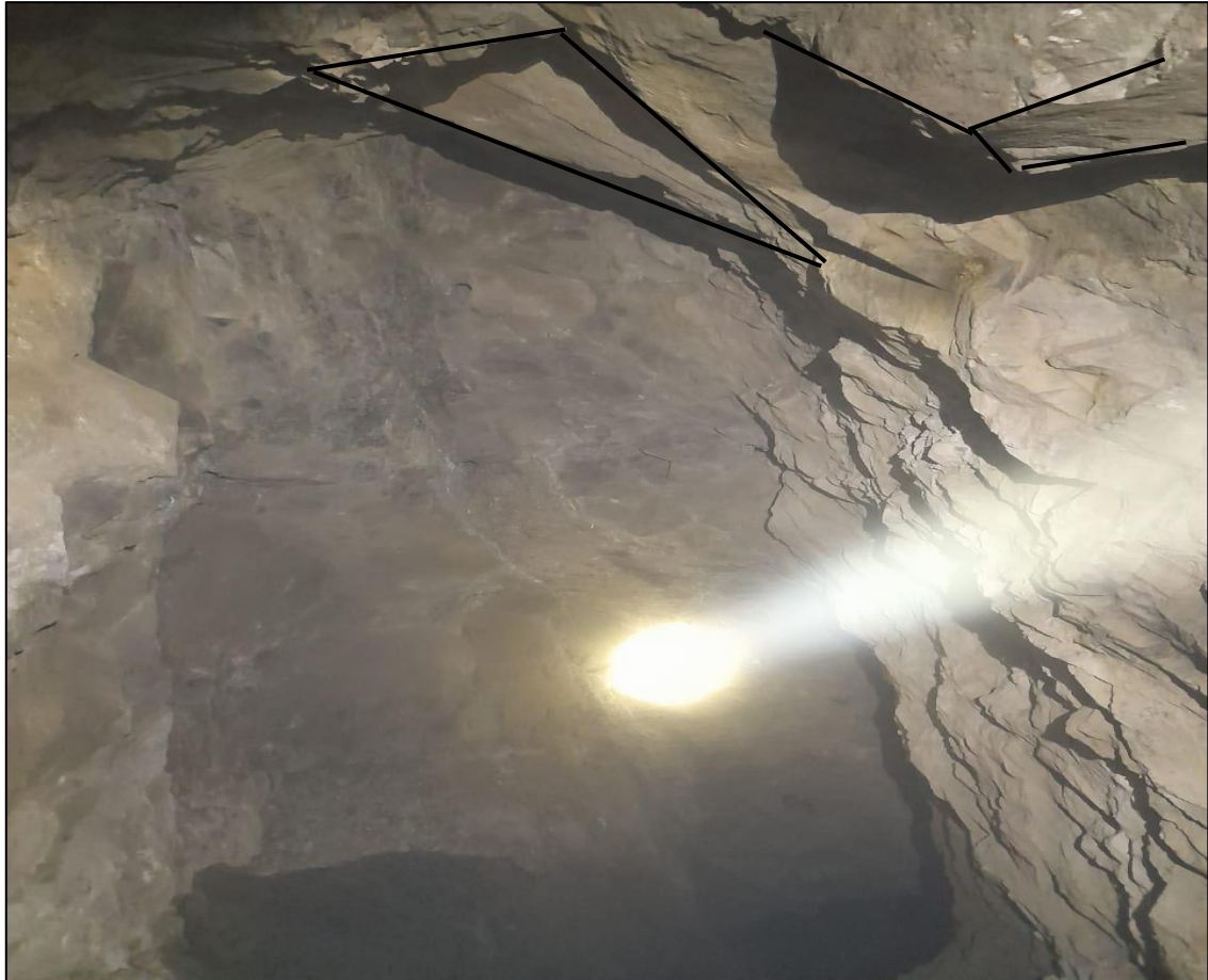
Foto 2. Se muestra sistema de cuñas con probabilidad de caer debido a las cargas gravitacionales.
