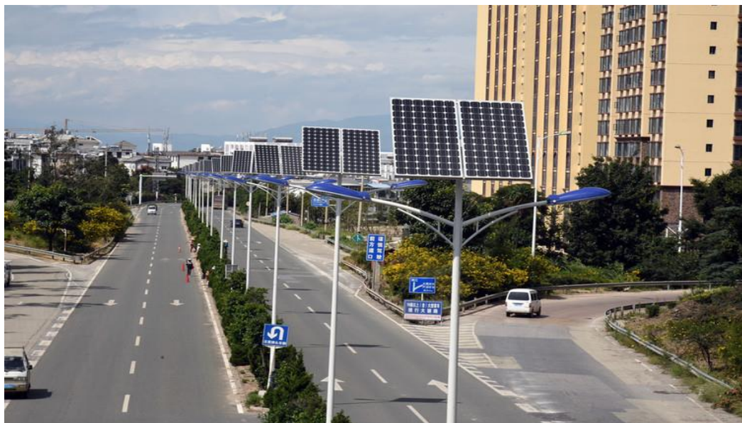
Figura 65. Paneles Fotovoltaicos, Banco de Desarrollo de Asia.
