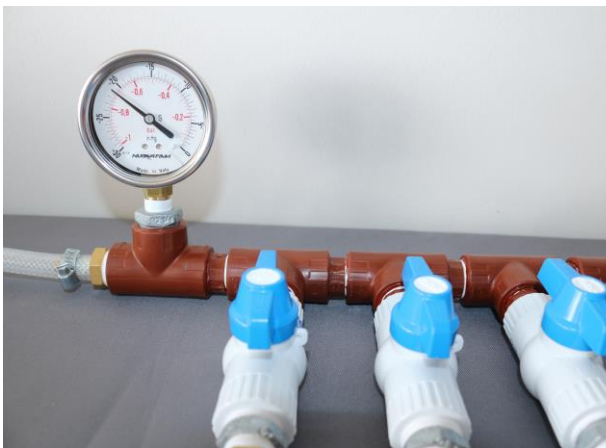
Figura 66. Monitoreo de la presión negativa del circuito mediante manómetro
