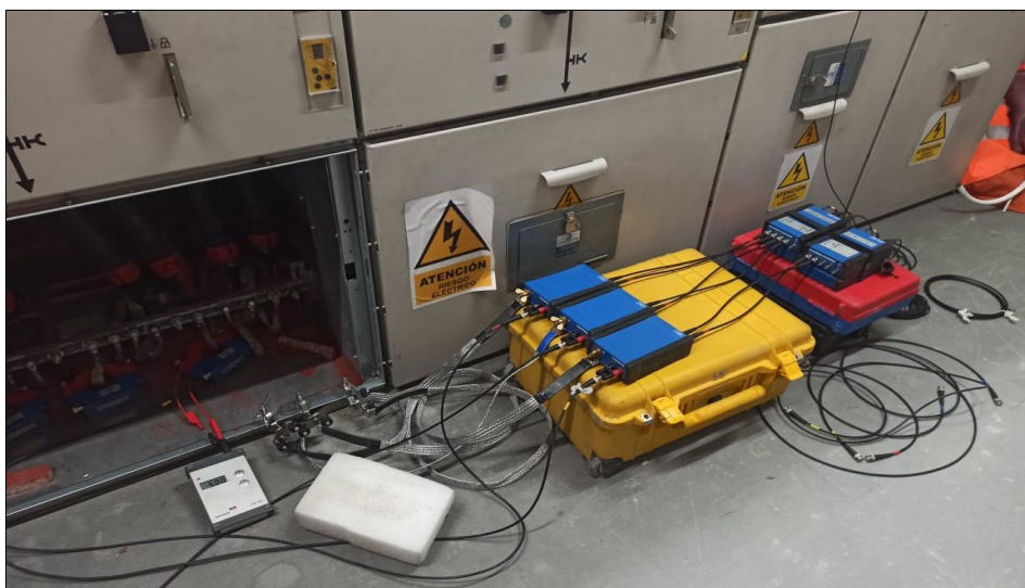
Figura 27: Cables de prueba de equipo MPD 800
