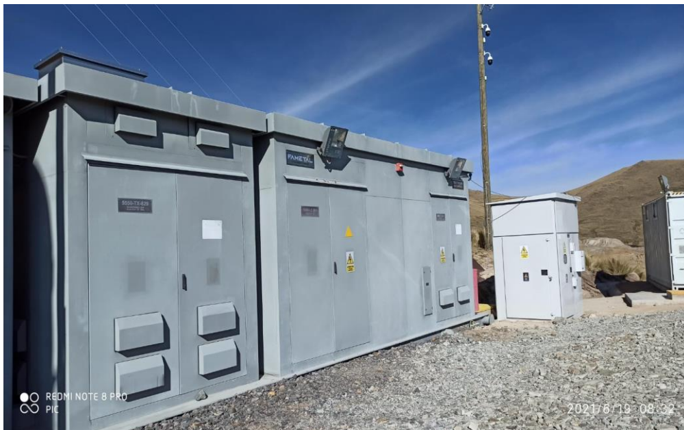
Figura 25: Subestación Skid TMF relaves
