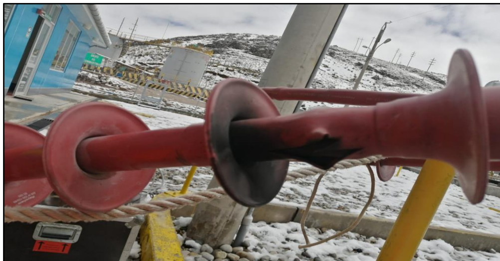
Figura 6: Falla en cable de media tensión
