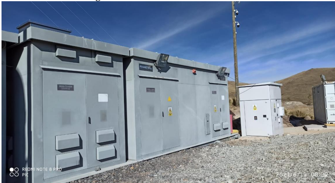
Figura 22: Subestación Skid 22.9/4.16kV
