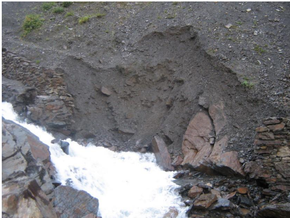
Figura 59. Quebrada Jilari, durante un evento de lluvia, el flujo erosiona el cauce.
