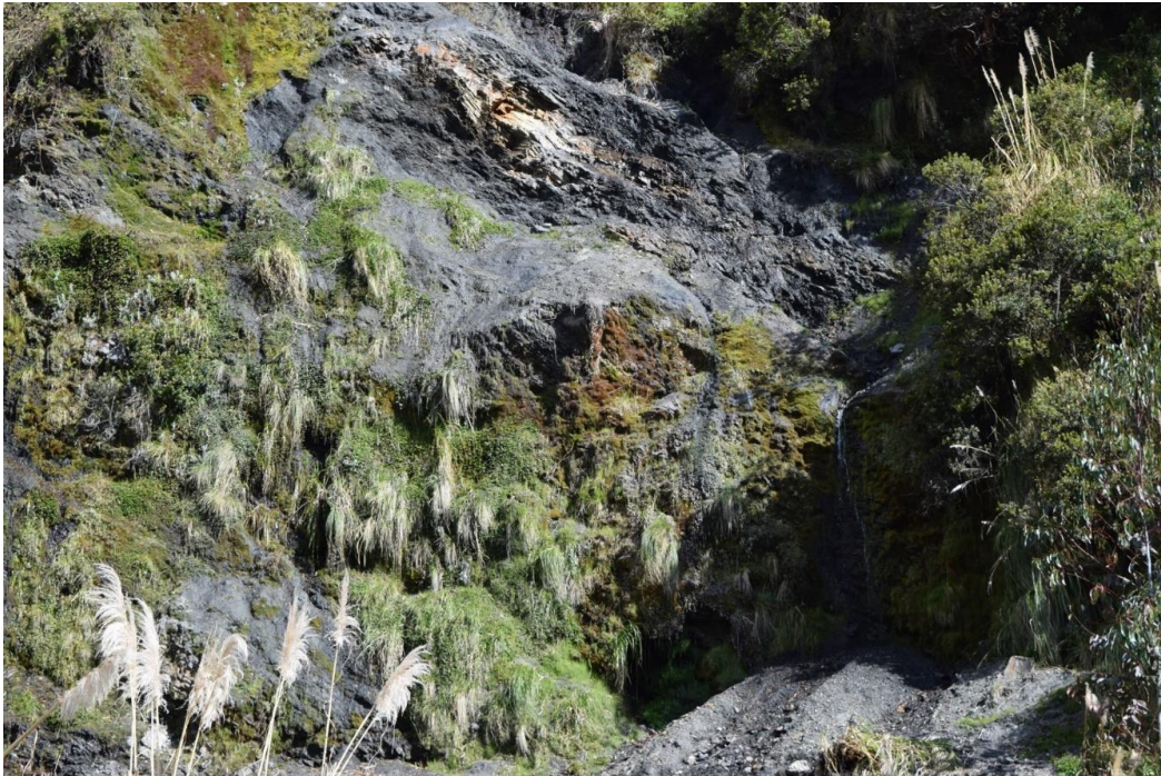
Figura 29. Flujo de agua en el talud Jilari que lo desestabiliza (Dic. 2015).
