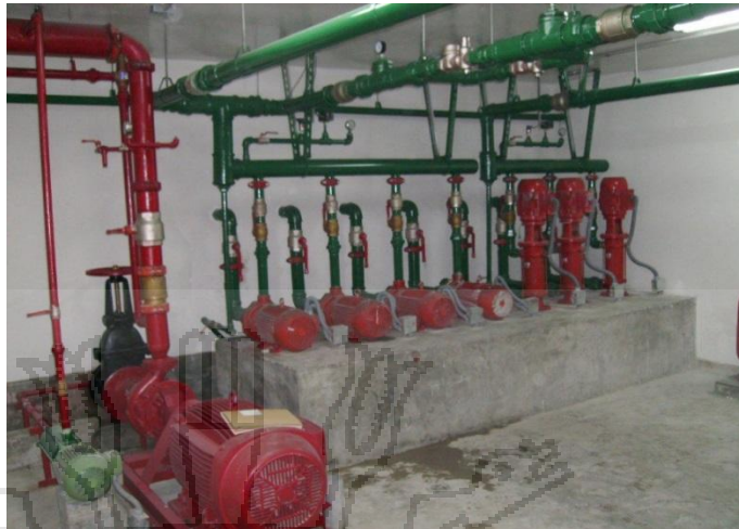
Figura 19: Cuarto de Bombas
