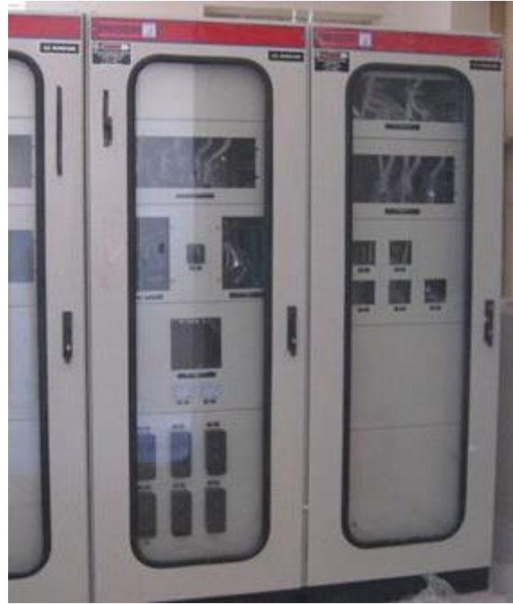
Figura 8: Tableros Edificio de Control S.E. Huancané.
