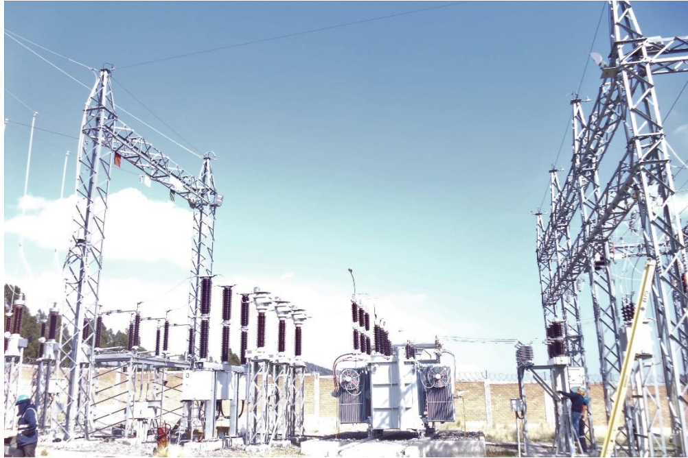
Figura 3: Sub estación de distribución Huancané
