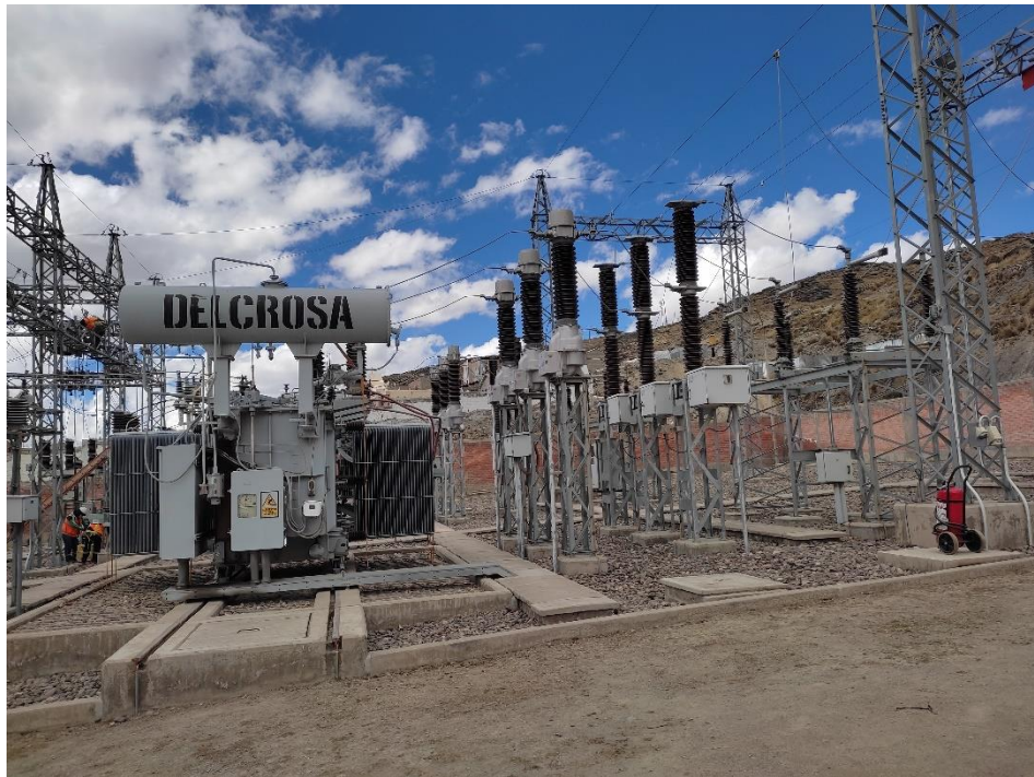
Figura 4: Sub estación de distribución Ananea
