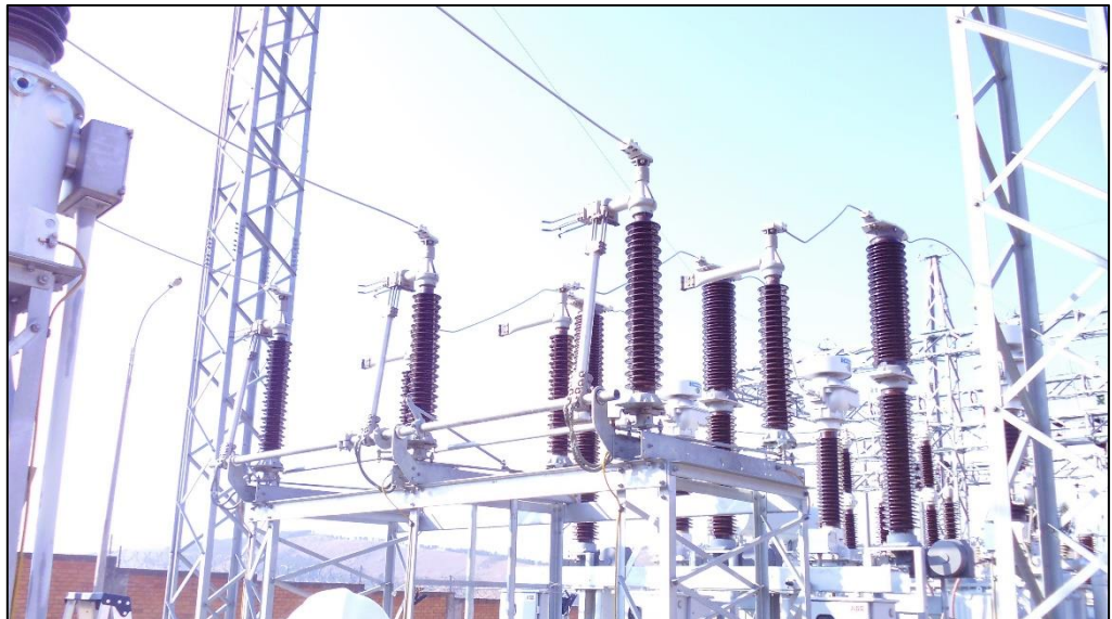
Figura 6: Seccionadores de Barra, Interruptores de Potencia S.E. Huancané.
