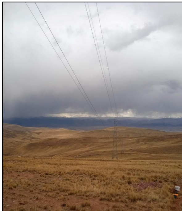
Figura 9: Soportes L.T. tramo Azángaro - Putina.
