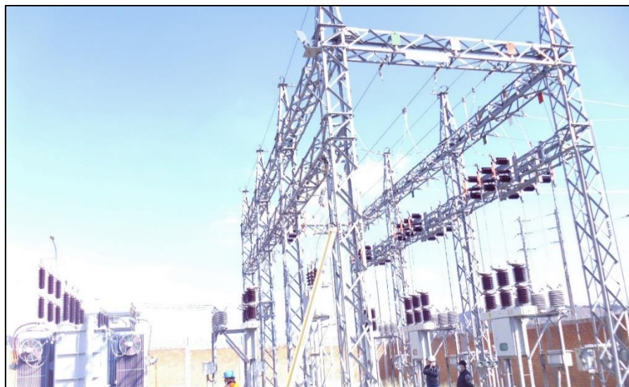
Figura 5: Seccionadores de Barra, Interruptores de Potencia S.E. Huancané.
