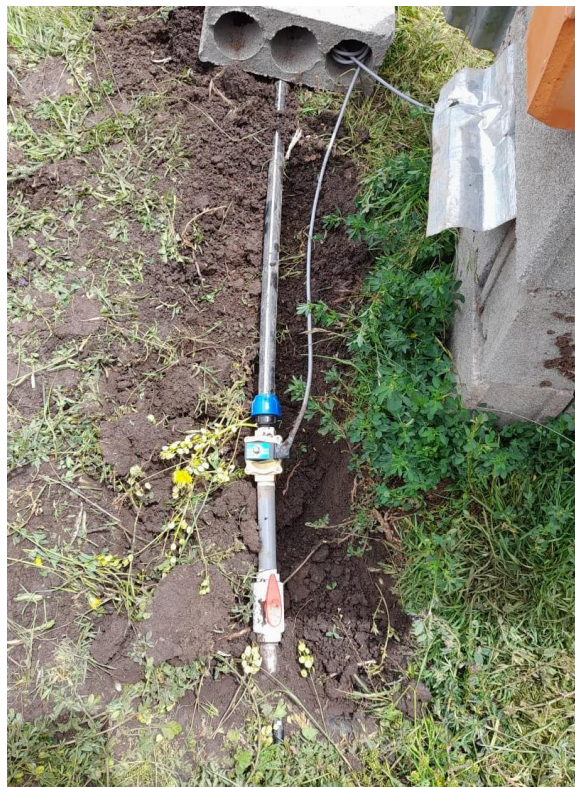
Fig. A.14 La llave de paso seguido de la válvula solenoide conectada al sistema
