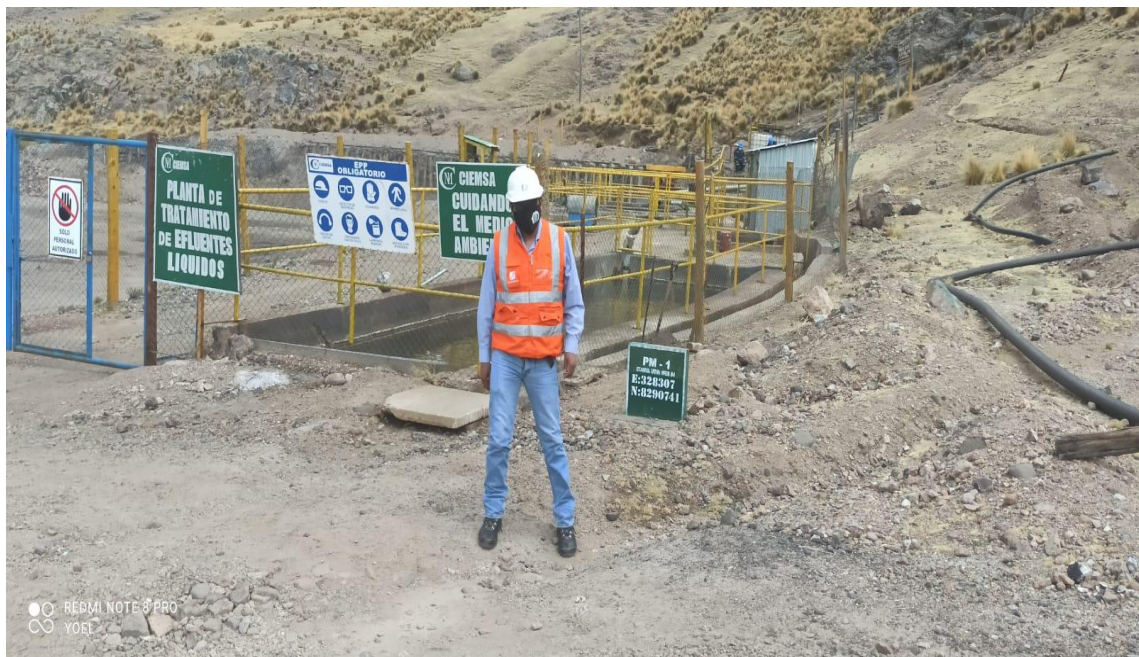
Figura C.16. Planta de tratamiento de Efluentes Líquidos
