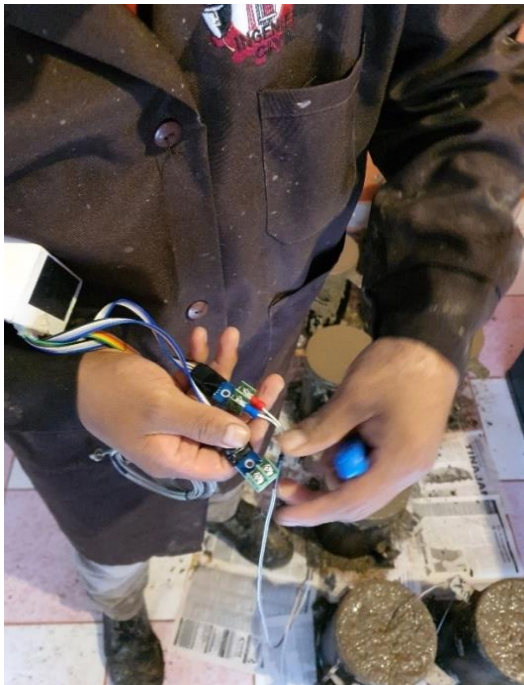
Fotografía 23. Instalación de los dos sensores al módulo registrador de temperatura
