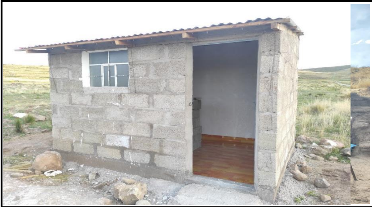
Fotografía 61. VISTA DEL COLOCADO DE PISO DE PVC DISEÑO MADERA DECORATIVO 1.5m X 20 m X 3 mm
