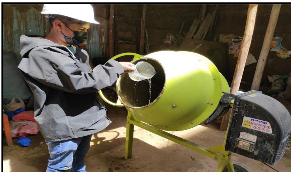
Fotografía 18. VISTA VISTA DEL AGREGADO DEL AGUA Fecha: 09/06/2021
