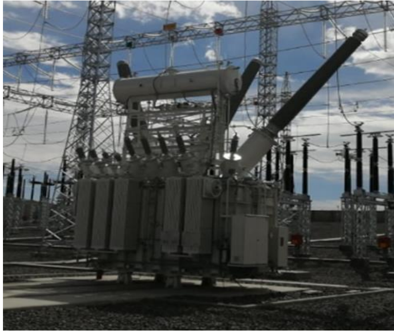
Figura 1: Transformador de potencia 20MVA Elaboración propia
