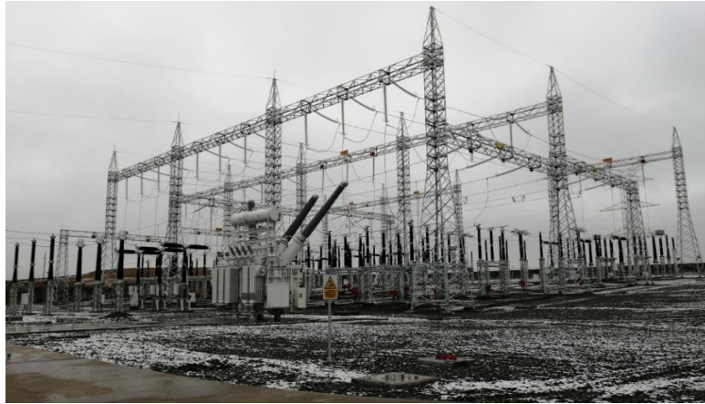
Figura 6: Fotografía Real S.E. Chilota 220/22.9KV
