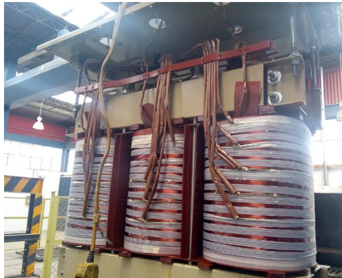
Figura 2: Parte interna del transformador de potencia
