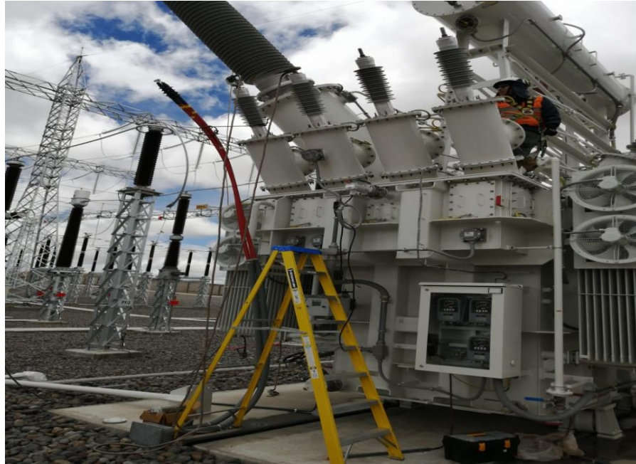
Figura 16: Desconexión de cables de los Bushing 22.9Kv Elaboración propia
