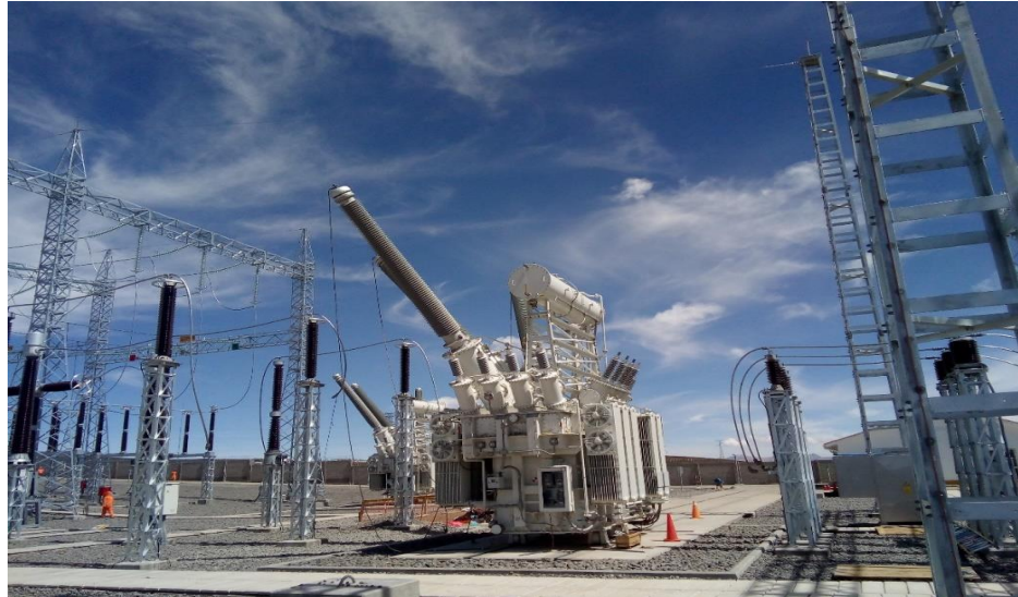
Figura 21: Transformador de potencia 20 MVA Elaboración propia
