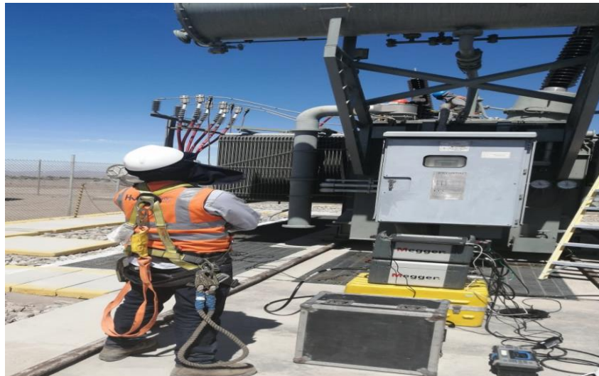
Figura 18: Prueba con equipo FRAX 101 MEGGER
