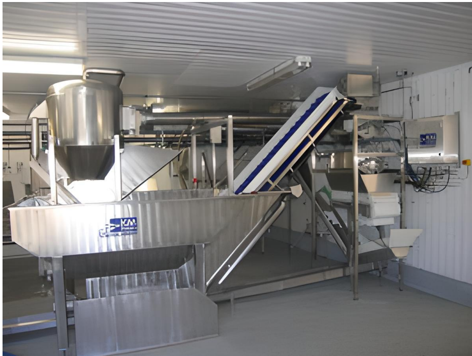
Fotografía 9. Modelo de planta piloto de procesamiento de residuos orgánicos de origen truchícola.
