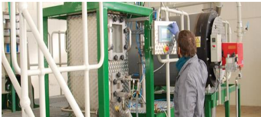
Fotografía 10. Sistema de tratamiento de residuos sólidos orgánicos de pescado y efluentes para su utilización en harina residual y aceite de pescado.
