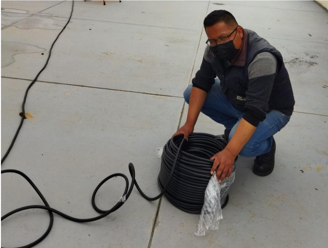
Cableado del sistema fotovoltaico en la azotea de la EPIME UNA-Puno.
