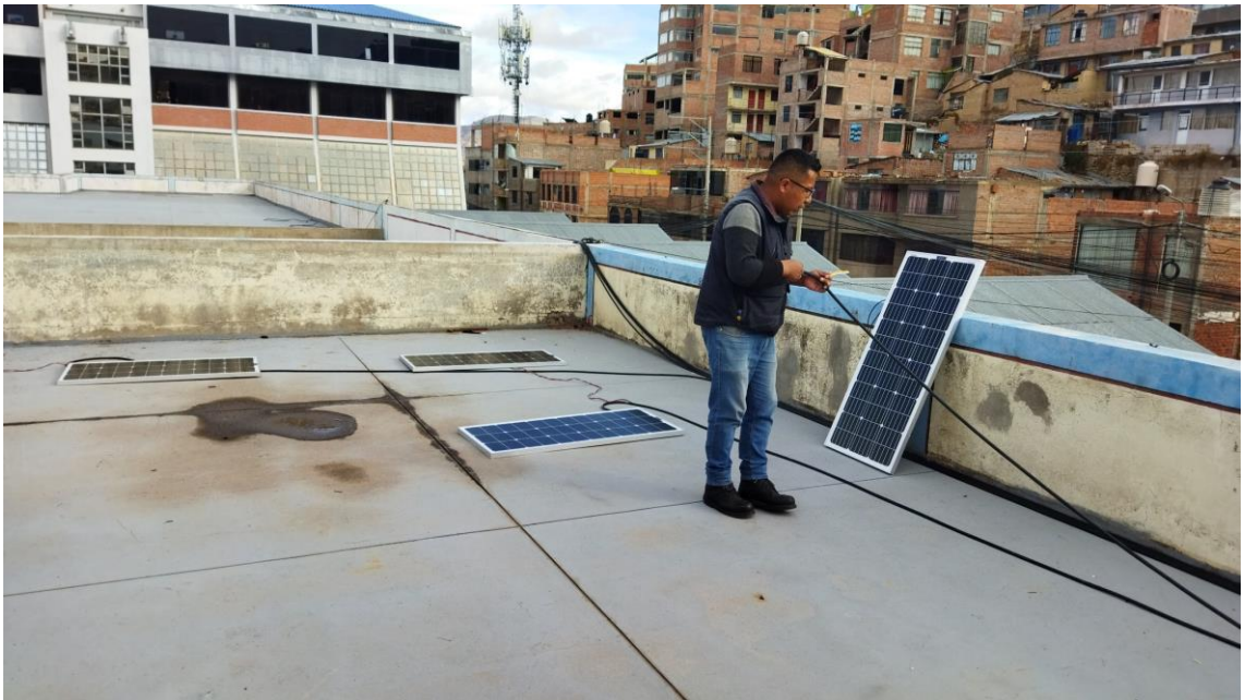
Cableado de las unidades experimentales (módulos fotovoltaicos).
