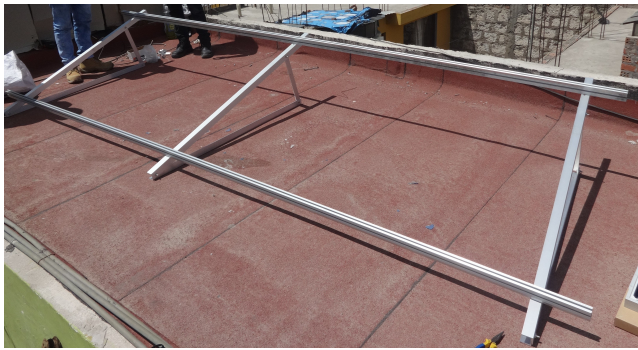
Estructura de Soporte de los Paneles Solares
