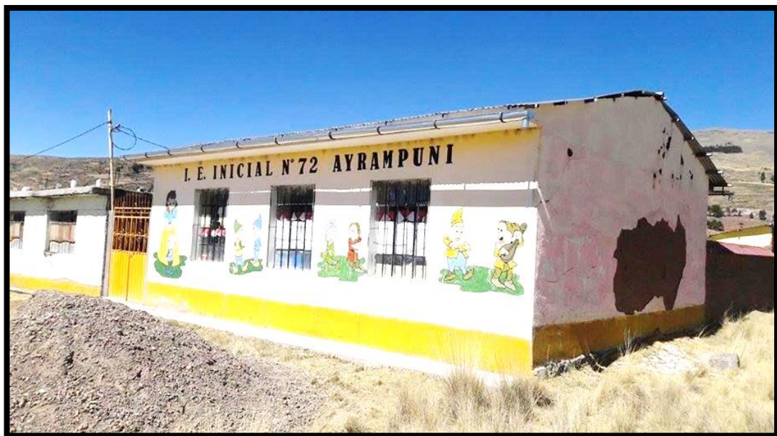
Figura 47. Foto del estado actual de la institución educativa inicial 72 ayrapuni como se aprecia está en un estado de abandono y deterioro
