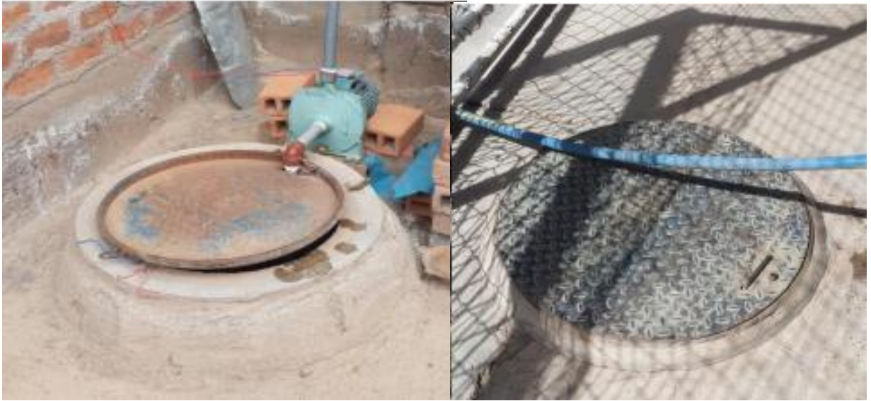
Figura 18. Pozos ubicados a 50m y 200m de la planta de tratamiento Chilla
