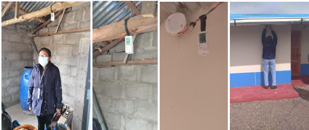
Figura 29. Instalación de los equipos termohigrómetros en los ambientes de medición.
