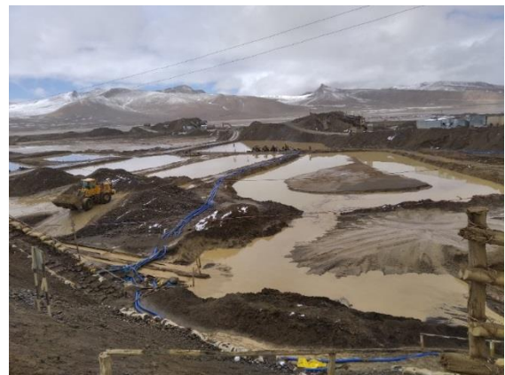
Fotografía 12. Pozas de sedimentación y clarificación para recirculación.
