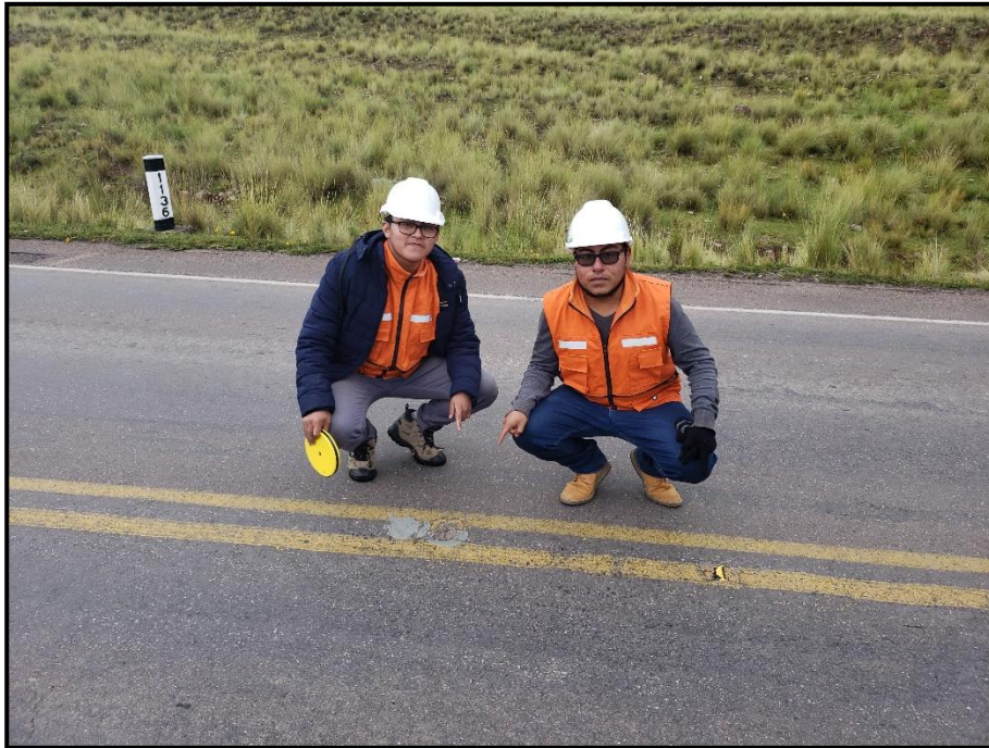
Figura 22: Falta de mantenimiento en tachas
