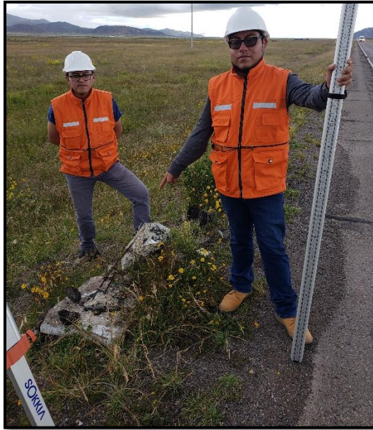
Figura 20: Poste kilométrico destruidos
