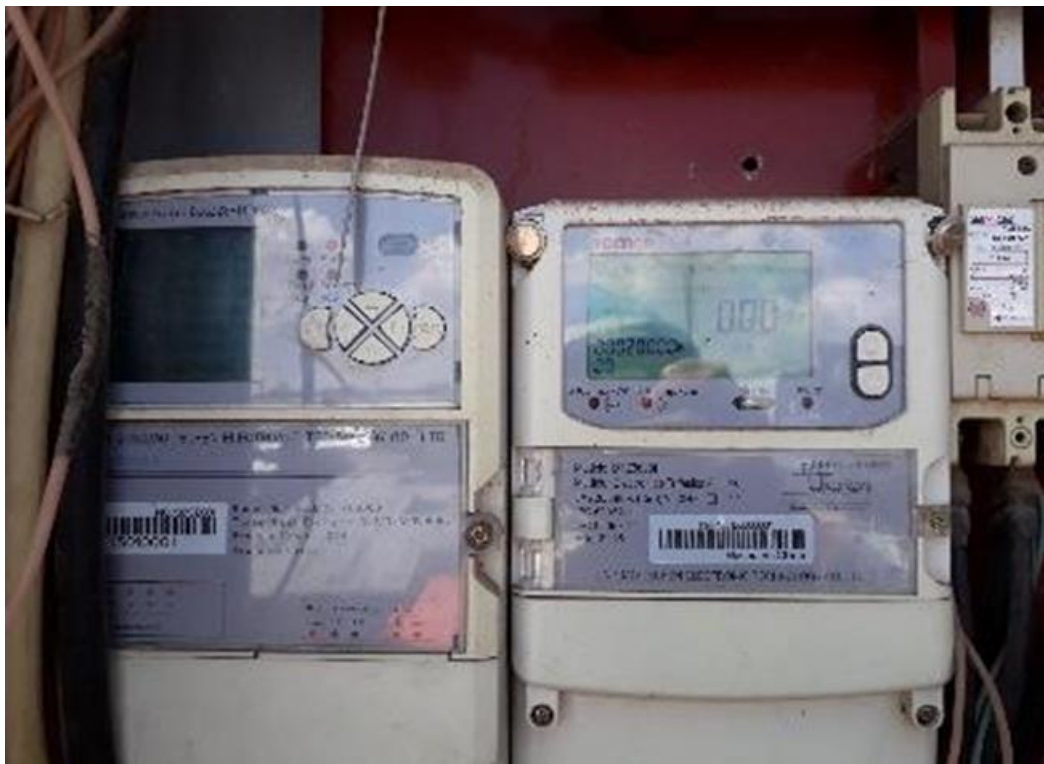
Figura 20. Instalación de concentrador en gabinete del tablero en la estructura de la subestación
