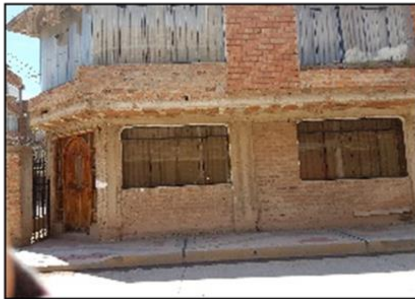
Figura 28. Ladrillos mal aparejados y diferente tipo de ladrillo
