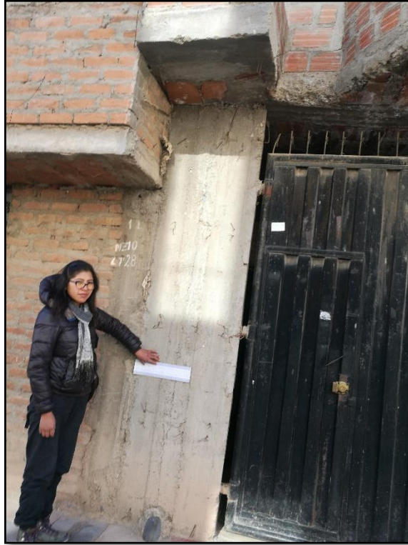
Figura 60: Desnivel de pisos y no existe junta sísmica entre viviendas
