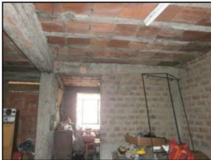
Figura 45. Elementos de concreto armado, de f'c = 130 \text{ Kg/cm}^2 .
