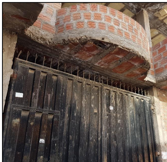
Figura 63: Fierro descubierto y corroído de la losa del techo.
