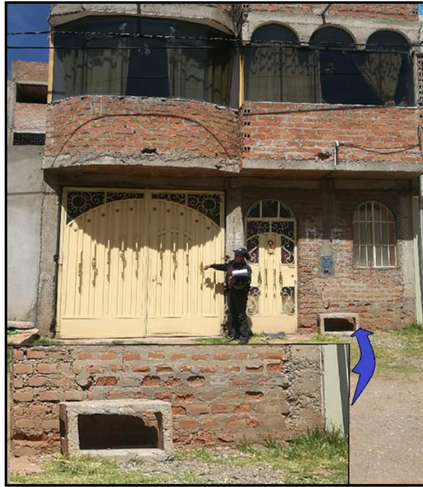
Figura 21. Se observa el deterioro de las unidades de albañilería debido a las precipitaciones pluviales
