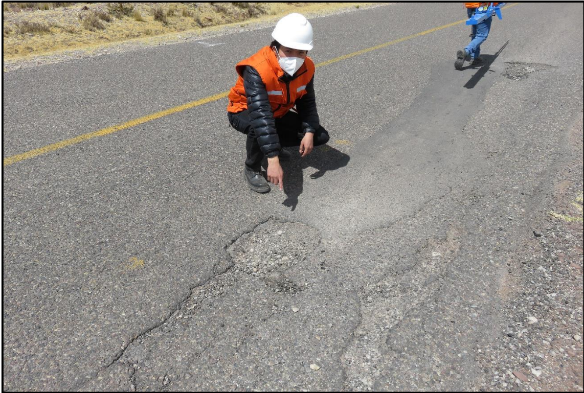
Figura 18: Presencia de bache y ligero ahuellamiento
