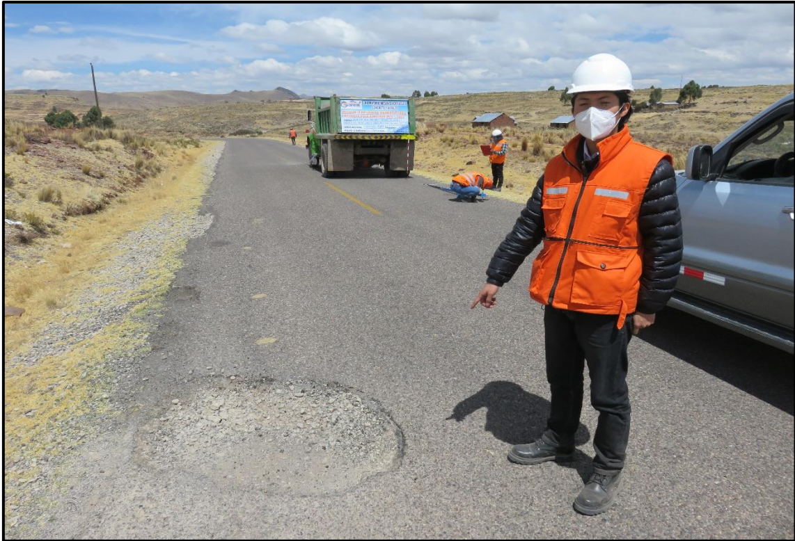
Figura 16: Presencia de Bache
