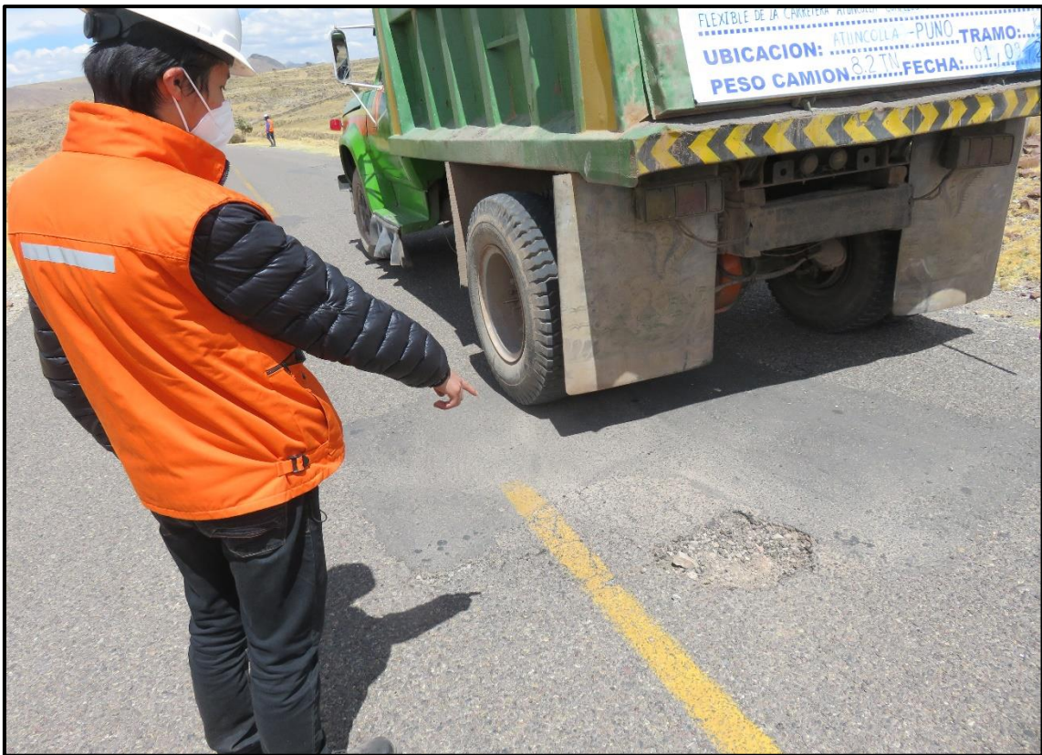
Figura 17: Presencia de Bache
