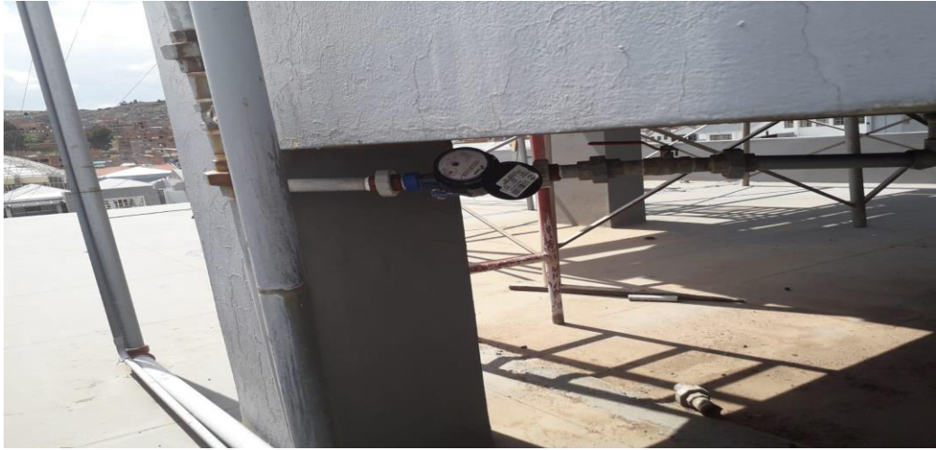
Foto 18.3: Medidor para agua instalado en la FIA
