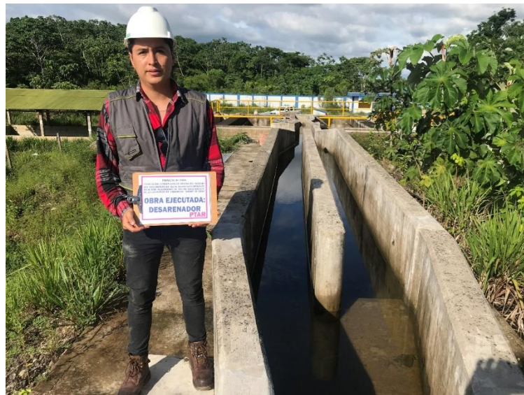
Figura 19 Desarenador “PTAR LABERINTO”
