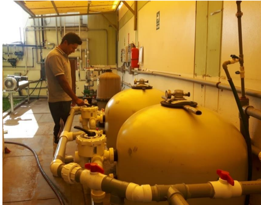
Figura 10. Filtros de arena y filtros de tierra diatomea
