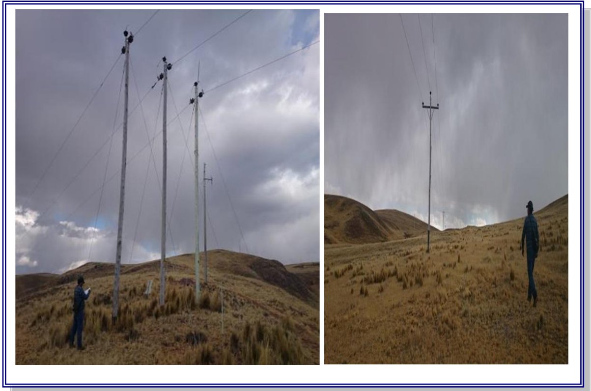
Estructuras Antiguas línea 22.9 Kv alimentador 9001
