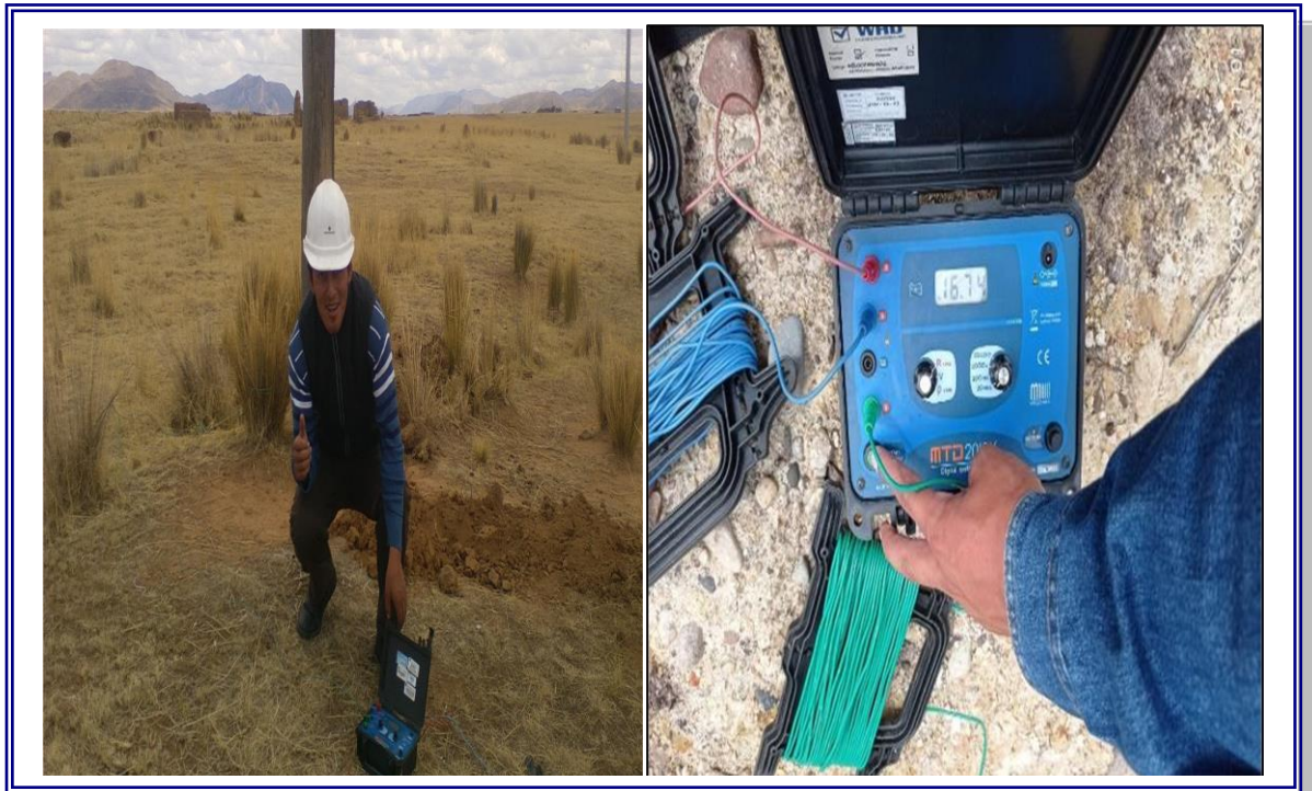
Realizando la medición de PAT de la línea de Media Tension
