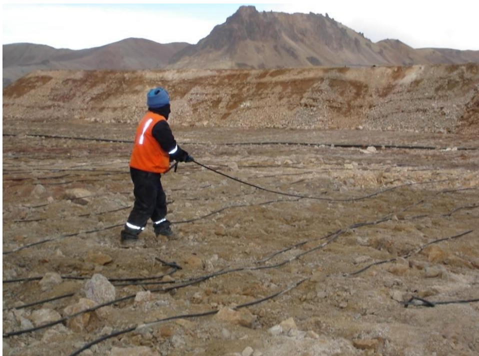
Figura 18. Purgado de Mangueras.
