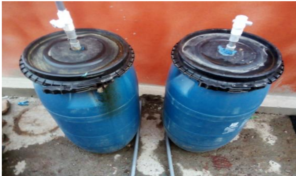
Figura 21: Tanques de digestión.
